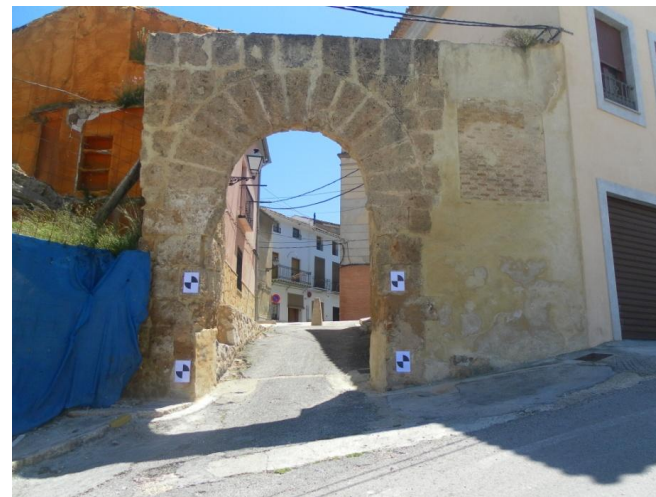
Figura VI. Estado actual de la Puerta de Valencia. Existe peligro de derrumbe.
