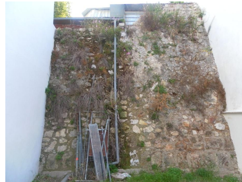
Figura XXIII. Paño completo; existencia de materiales impropios y acumulación de trastos.
