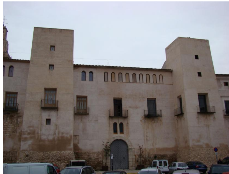
Figura II. Estado inicial de la fachada principal del Palacio.
