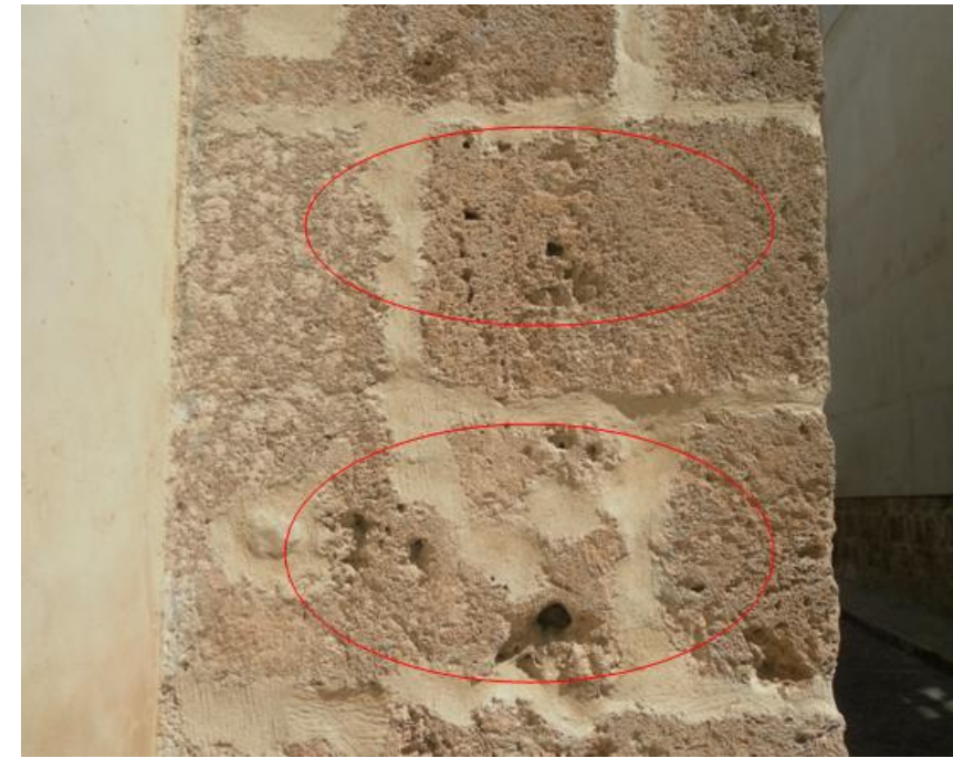
Figura IV. Alveolizaciones y picaduras.
