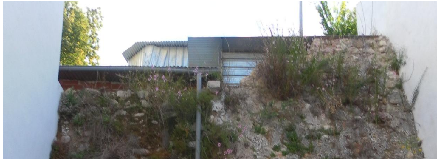
Figura IX. Estado actual de la parte superior del tramo de muralla.
