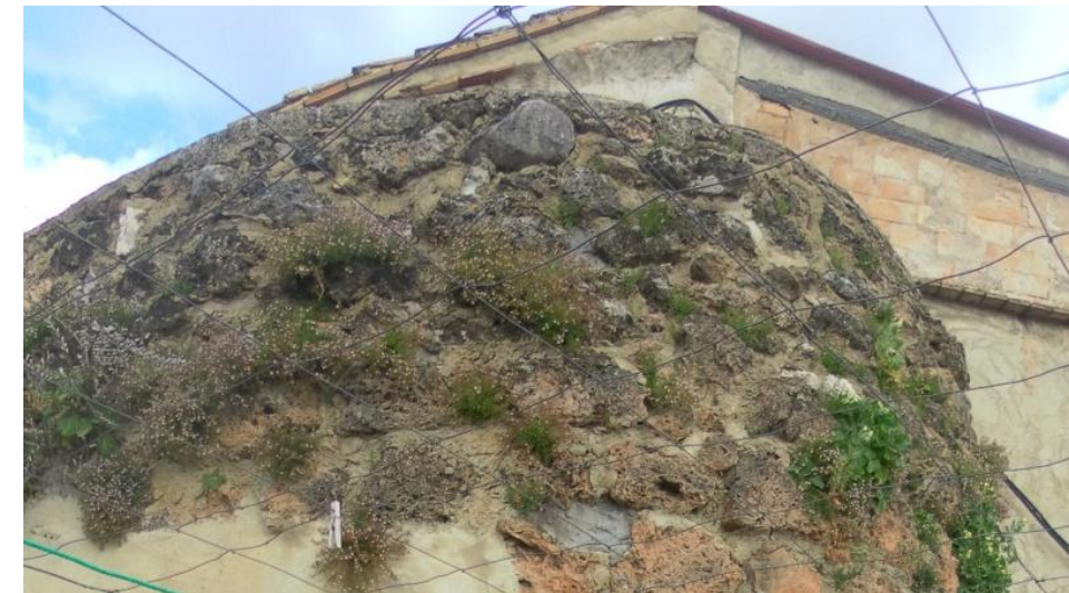
Figura X. Estado actual de la parte superior de la torreta de Guaita.
