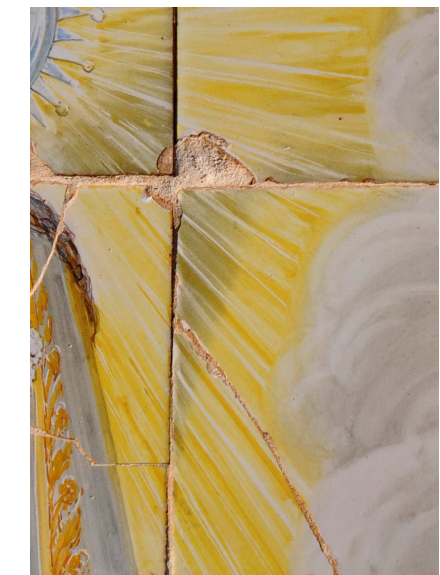
Detalle fallo manufactura azulejo 5
