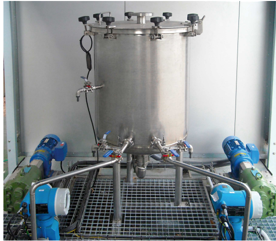
Figura 3.7. Tanque CIP instalado en la planta SAnMBR.
