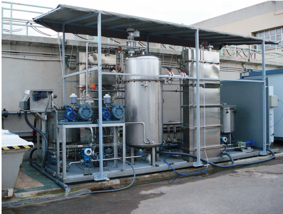
Figura 3.1. Vista general de la planta SAnMBR.
