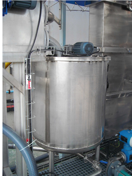
Figura 3.4. Tanque de regulación instalado en la planta SAnMBR.
