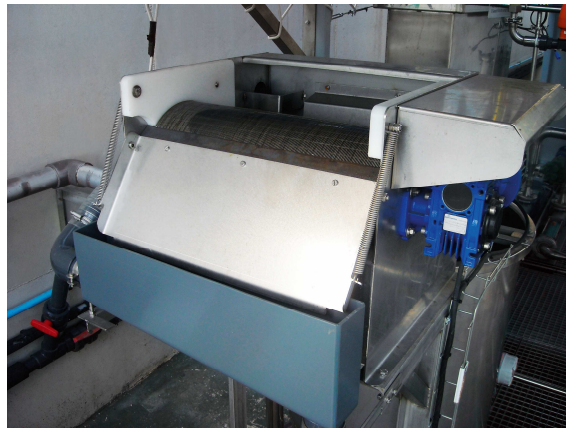
Figura 3.3. Rotofiltro instalado en la planta SAnMBR.
