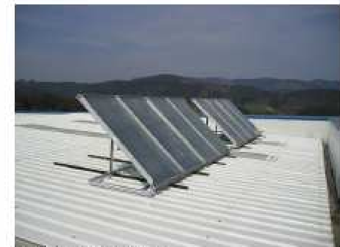
Colectores solares para ACS
