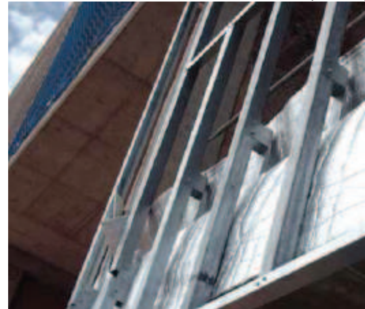
Edificio industrial para el hospital de Salamanca: tubulares de 80x80 cm pasantes por delante de forjado
