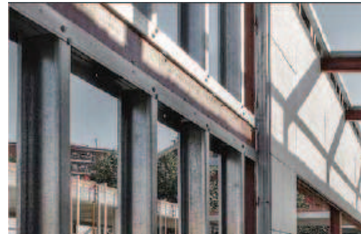
Guardería en Canovelles: estructura de acero pesado y subestructura de acero ligero.
