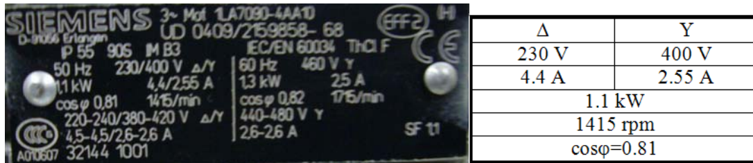
Figura A-3. Placa de Características de la máquina eléctrica Siemens sana
