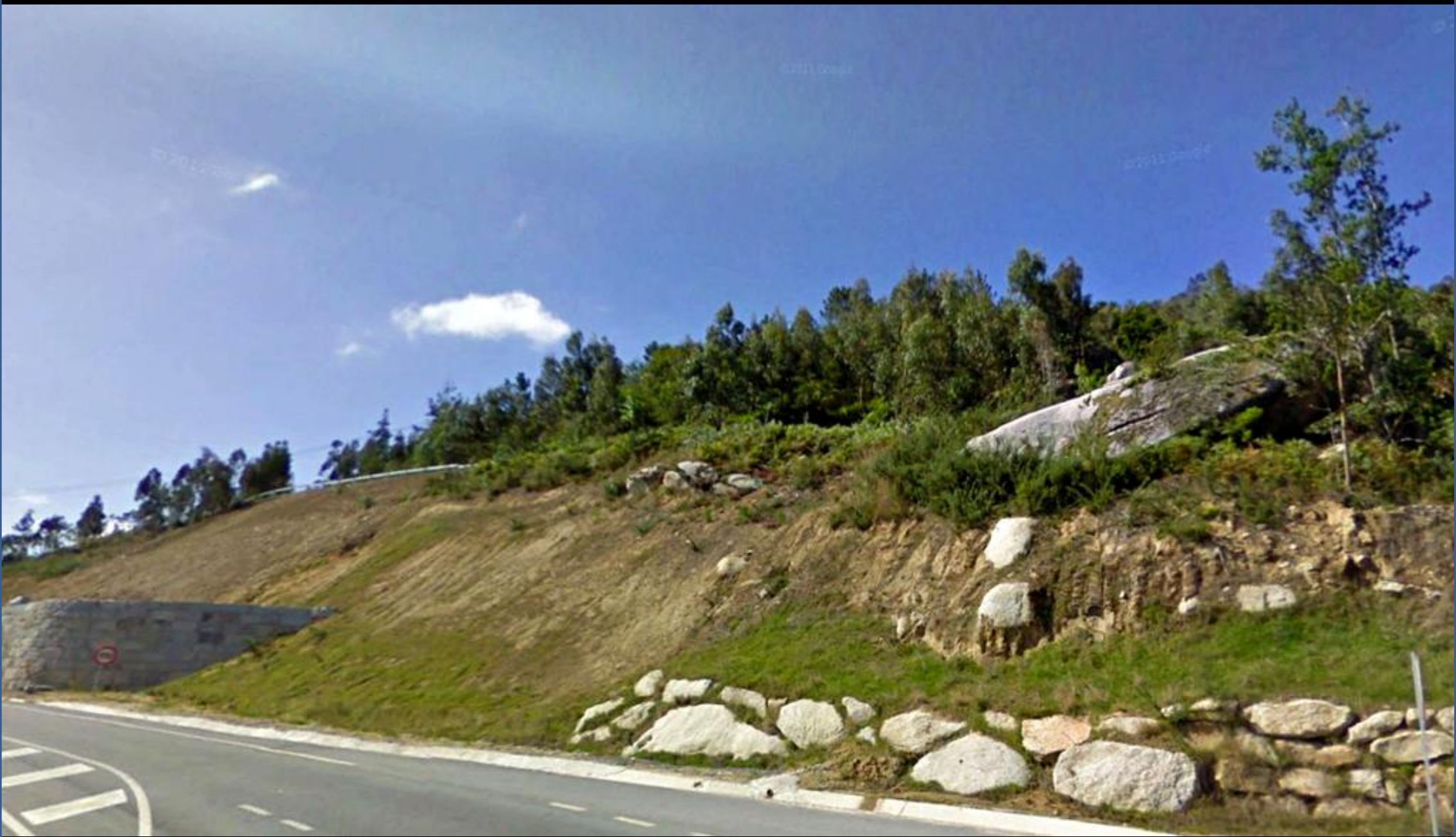
Talud tendido y actuación para su estabilización. Zona de granodioritas y Precámbrico. W de Bolmente, NE Hoja de Vivero, Lugo
