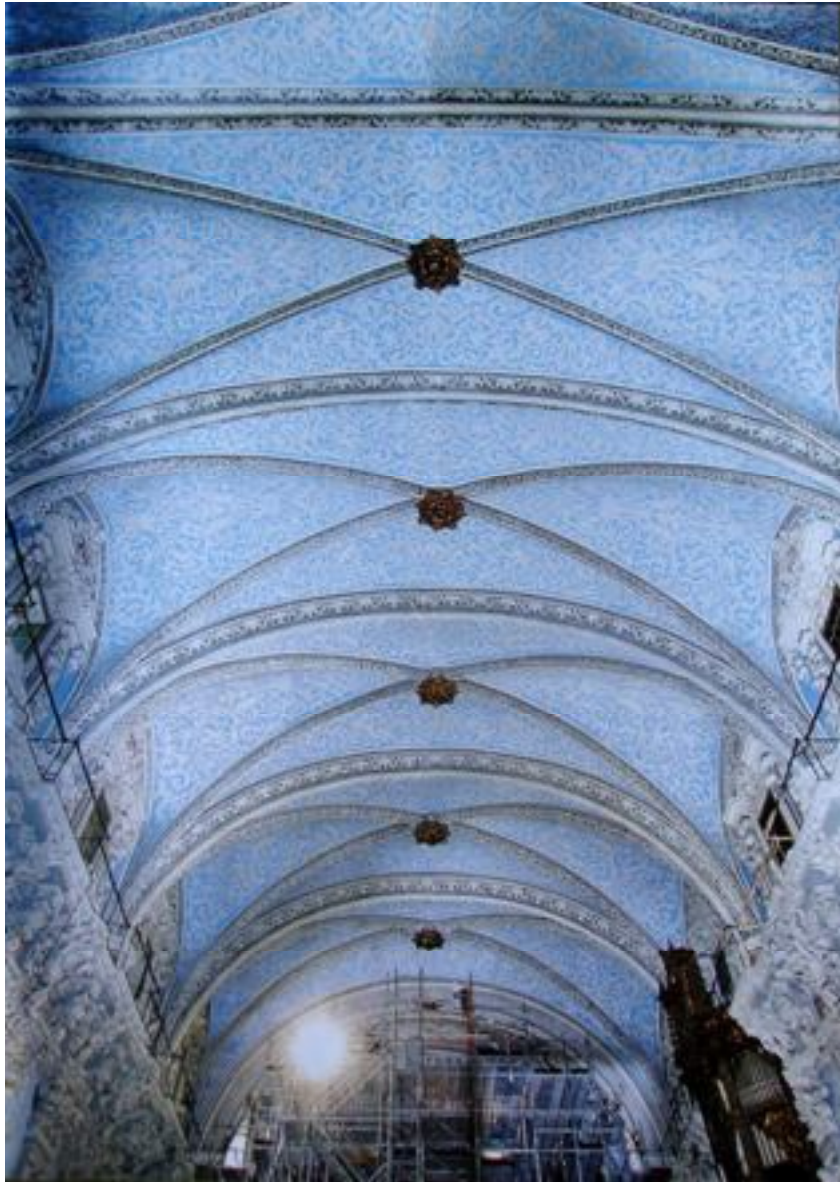
76. Restauración de la Iglesia de San Esteban de Valencia por Luis Roig D'Alós y Rafael Contreras Mongrell. (Años 70).
