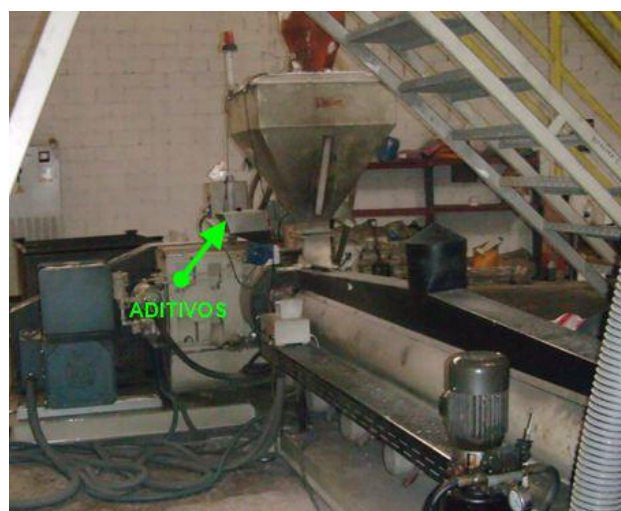
Figura 29: Caja donde se depositan los aditivos
