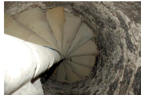
Fig VII.186: Vista inferior escalera de caracol.
