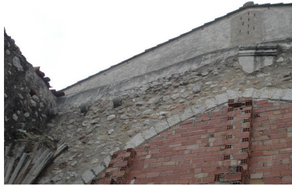
Figura 5.45. En esta imagen se pueden observar los restos del arco formero que quedan adheridos al muro
