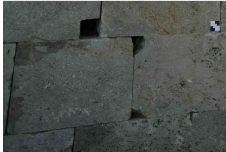
CAVI SULLA FACCIATA
