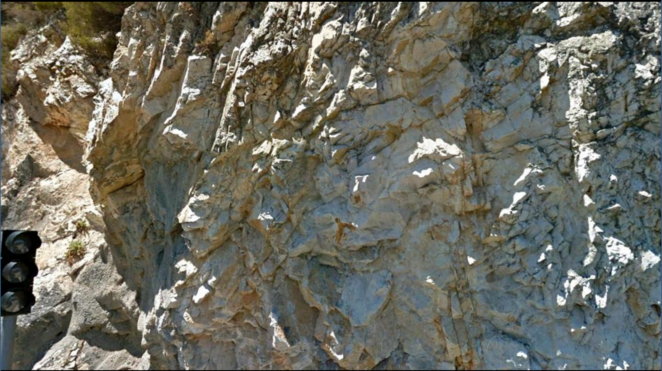
Cuarcitas del Devónico Sup. Cerca del túnel, junto a la cerrada, en el estribo der. Embalse de Camporredondo de Alba. Centro SW Hoja.
