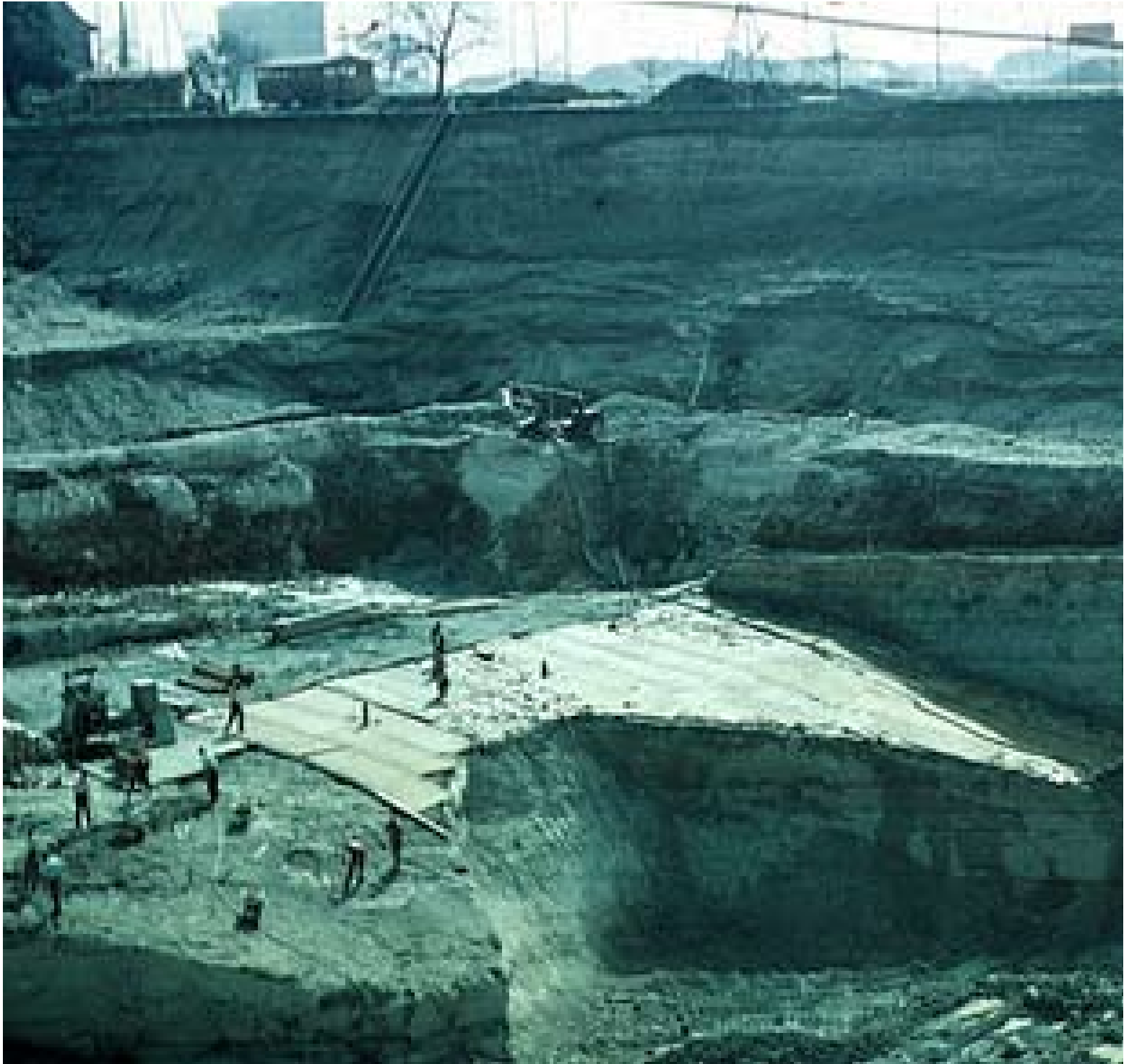
Dragado y excavación de la Presa de Birsfelden sobre el río Rhin, 1951
