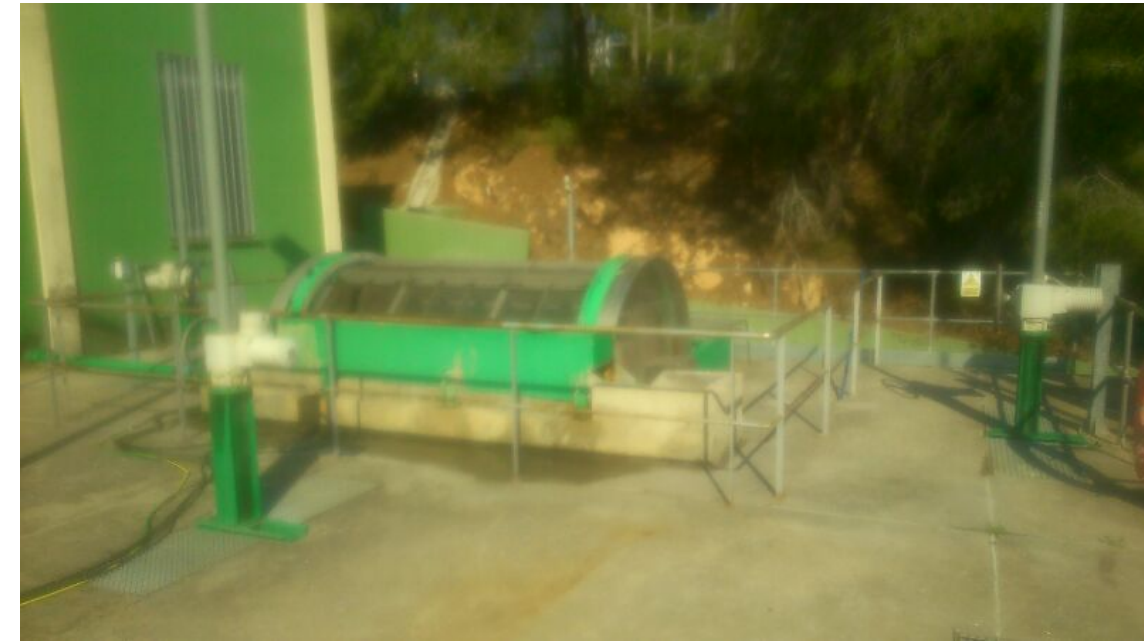
Ilustración 2: Macrotamiz de 10mm instalado en la ETAP "La Presa".
