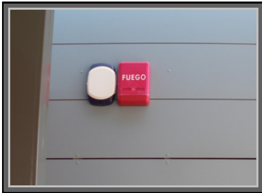
Ilustración 37. Sirena exterior edificio 1C.
