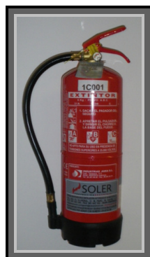
Ilustración 41. Extintor de Polvo ABC.
