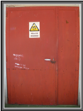
Ilustración 26. Puerta acceso cuartos productos químicos.
