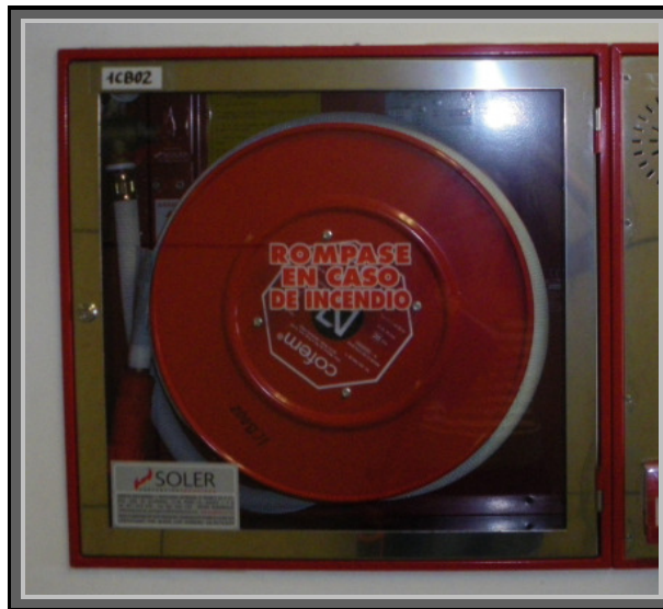
Ilustración 40. Boca de Incendio Equipada (BIE).
