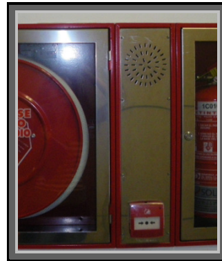
Ilustración 38. Sirenas interiores edificio 1C.
