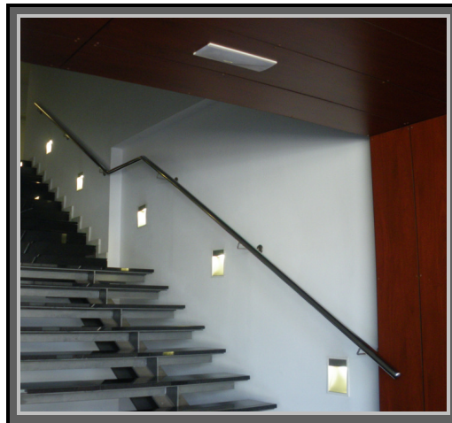
Ilustración 43. Aluminado señalización y emergencia de escaleras. Escalera 3, edificio 1C.
