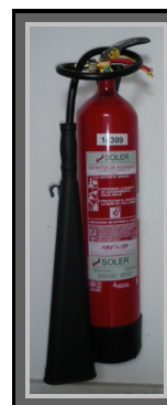
Ilustración 42. Extintor de CO 2 .
