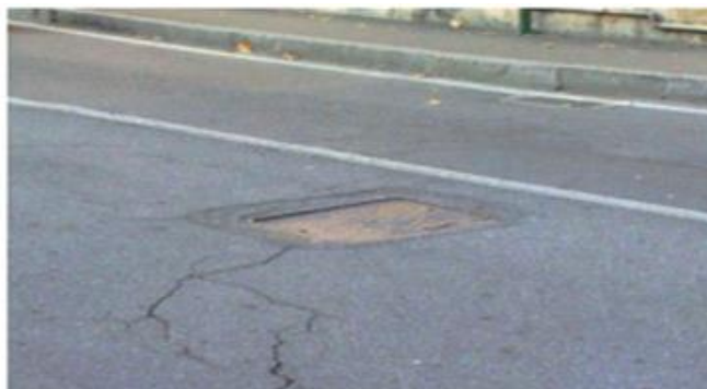
Figura 8: Chiusino con avvallamento e fessure
