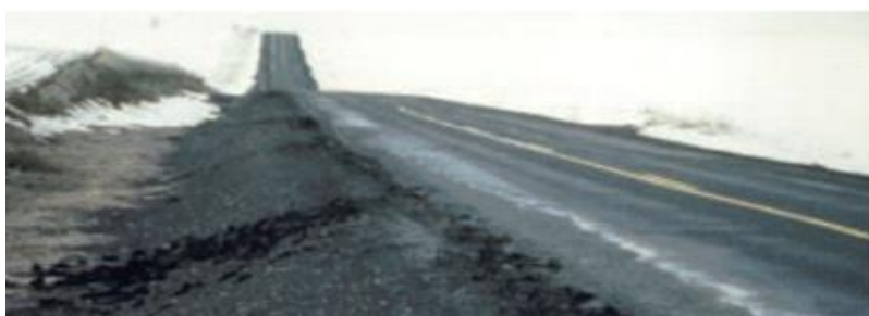
Figura 14: Distacco della pavimentazione ai margini della strada
