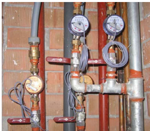
Imagen 21.3: Contadores de agua fría y caliente.
