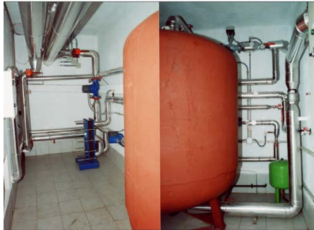
Imagen 20.33: Depósito ACS SAN FERNANDO
