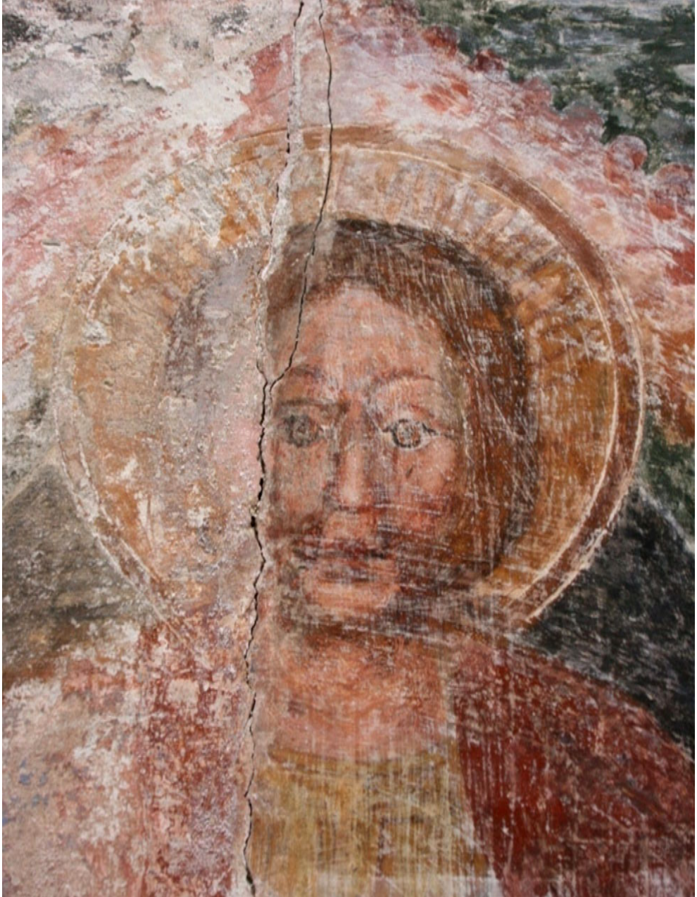
Figura 82 Giner Cordero E., Particolare del volto del Pantocrator raffigurato sulla volta dell'abside dove si apprezzano dei segni dello descialbo, eseguitosi con mezzi meccanici abrasivi, e segni della "verniciatura-consolidamento" a cera sulla parte destra , Chiesa di san Martino a Deggio, Quinto, 2008.
