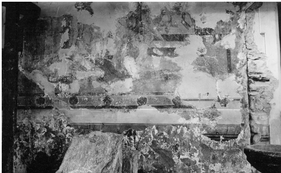
Figura 94 Fotografia dell'Interno della chiesa durante il processo di restauro, 1948 ca. AUBCBZ. Chironico. S. Ambrogio.
