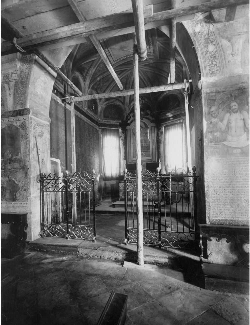
Figura 42 Terza cappella durante i lavori di restauro. 1931 ant. Fotografia b/n AUBCBZ Archivio grafico, 143 Lugano, S. Maria degli Angeli.
