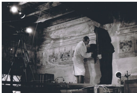
Figura 190 Carlo Mazzi insieme a Crivelli durante il restauro della casa dei Landfogti, Rivera. 1959 post. Archivio Silvia Mina-Mazzi, Tegna.
