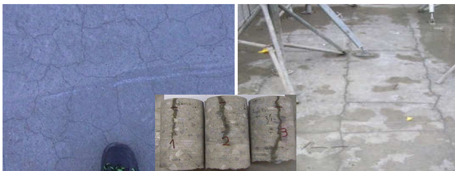
Figura 4.16. Retracción plástica elevada en losas de hormigón (Peterson, 2008)
