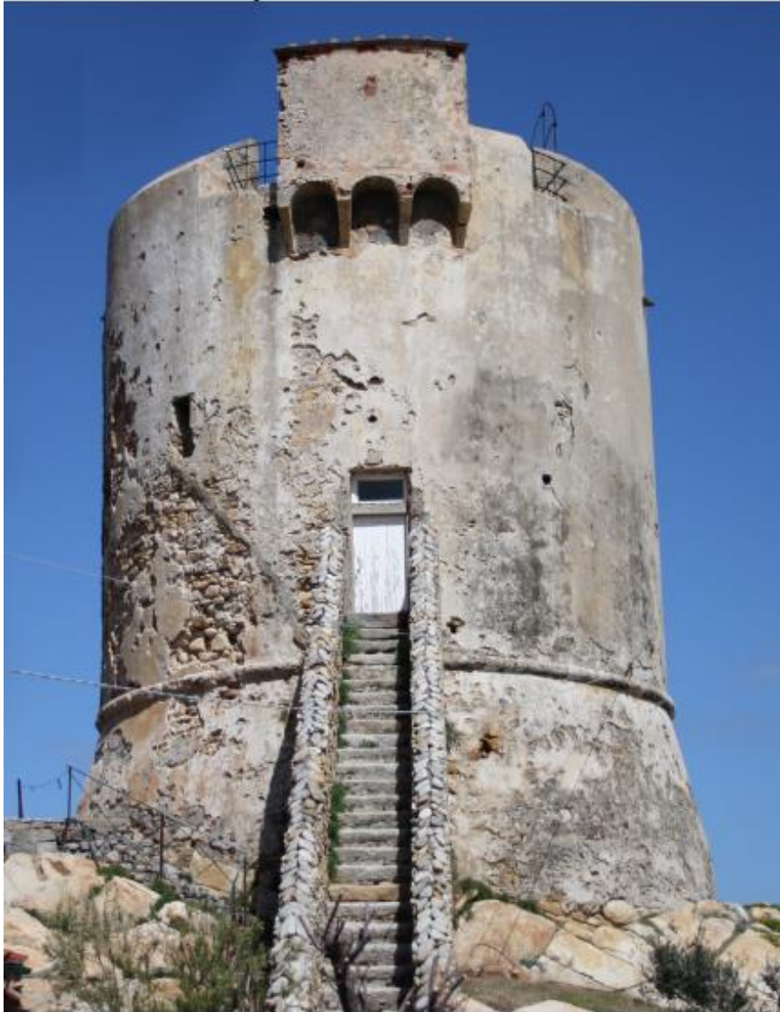
Foto 140 Foto dell'entrata alla torre. Si evidenziano la scala e i danni alla struttura
