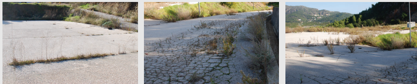
Vegetación aflorando entre las grietas.
