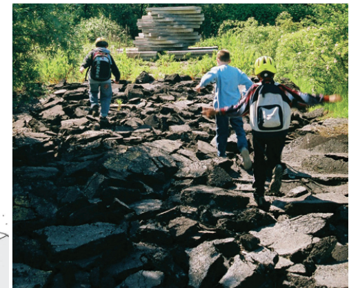
Ruptura de la corteza asfáltica generando huecos y cavidades
