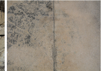
Corteza de hormigón
