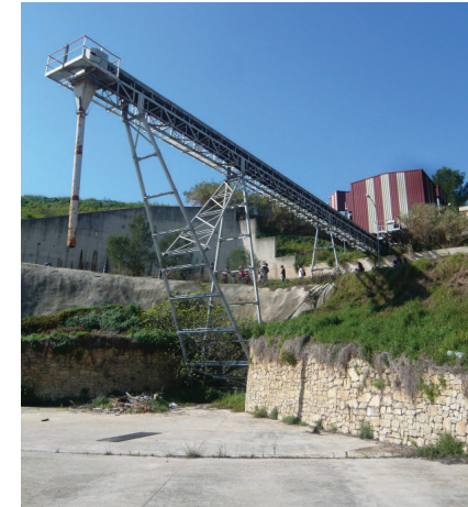
01 Vista cinta transportadora desde la plataforma
