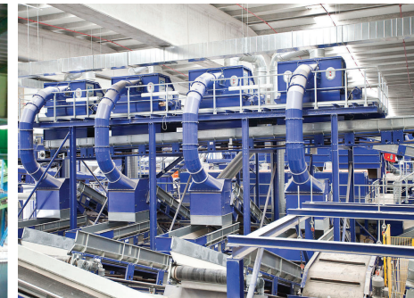
Batería de captaciones neumáticas
