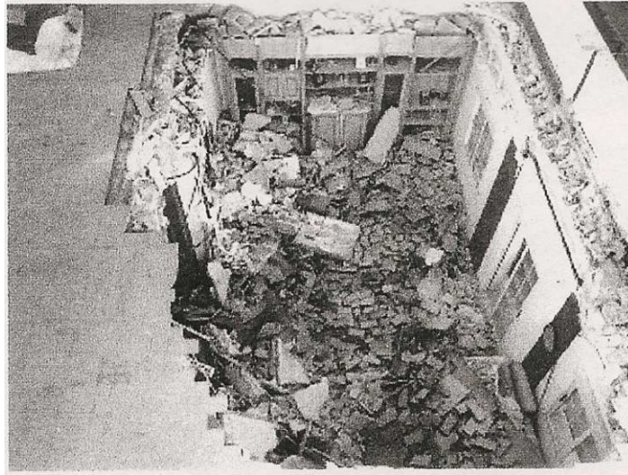
Fig. 5. Colapso del forjado de cubierta – 1ª crujía. 2011. Expte. de ruina 7/2011 del archivo del Ayuntamiento de Paterna.
