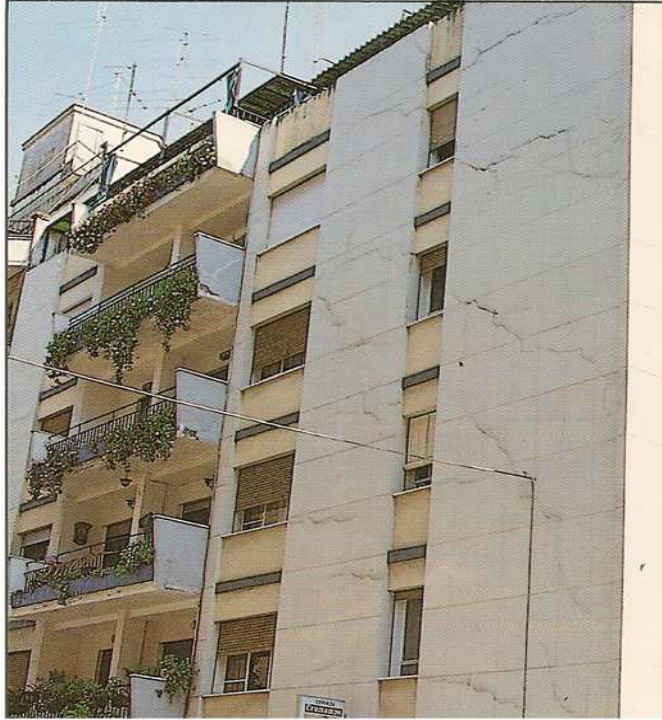
Fig. 1. Inicio de Orden de Ejecución para reparación de fachada y revisión estructural. 1988. Conceptos y Patología en la Edificación de Manuel Muñoz Hidalgo.
