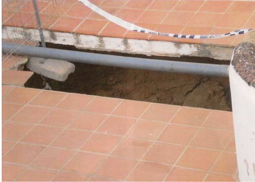
Fig. 38. Hundimiento de la calle y su solera. La tubería que se observa se colocó posteriormente para desviar aguas pluviales fuera de la zona afectada. 2012. Expte. 9/2012 Archivo del ayuntamiento de Paterna.
