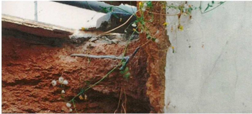
Fig. 31. Se observa la solera de la calle peatonal que se ha hundido y la tubería de agua potable con una deficiente reparación. 2012. Expte. 9/2012 Archivo del ayuntamiento de Paterna.
