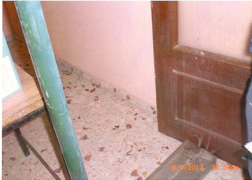
Fig. 21. Tabiquería sin apoyo en piso primero. 2013. Expte. 11/2013 Archivo del Ayuntamiento de Paterna.
