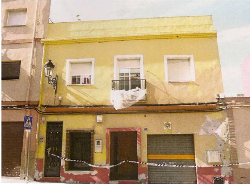
Fig. 6. Fachada con antepecho de cubierta suelo. 2011. Expte. de ruina 7/2011 del archivo del Ayuntamiento de Paterna.
