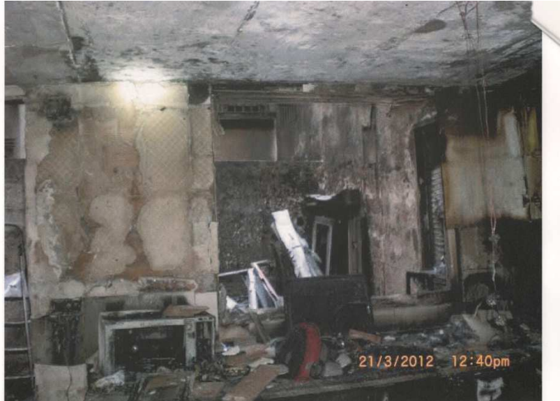
Fig. 10. Estado de la vivienda calcinada. 2012. Expte. de ruina nº 11/2012 del archivo del Ayuntamiento de Paterna.
