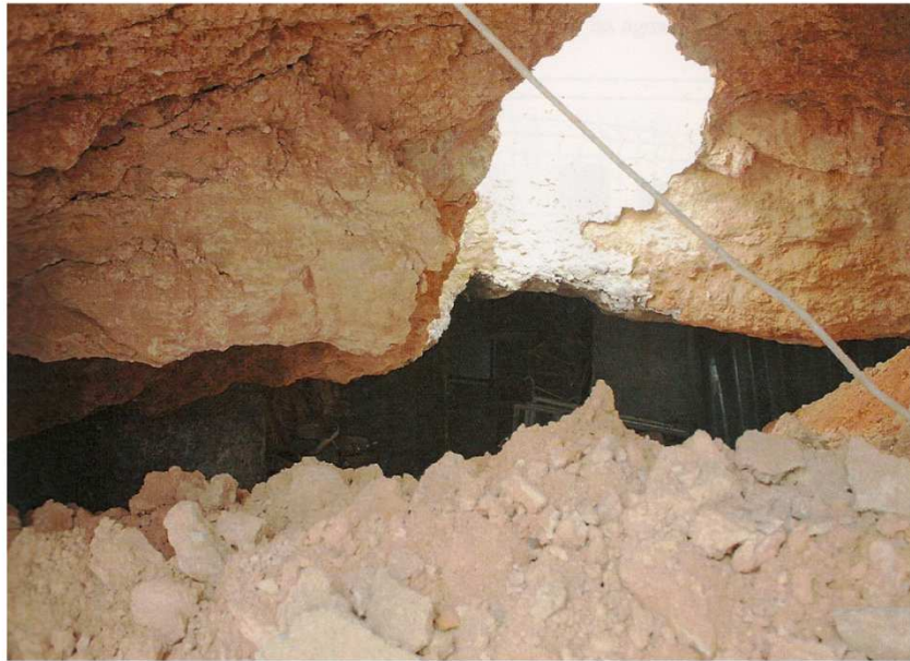
Fig. 29. Material desprendido de la losa de techo de la cueva, fisuras y reparación reciente de fisuras. 2012. Expte. 9/2012 Archivo Ayuntamiento de Paterna.
