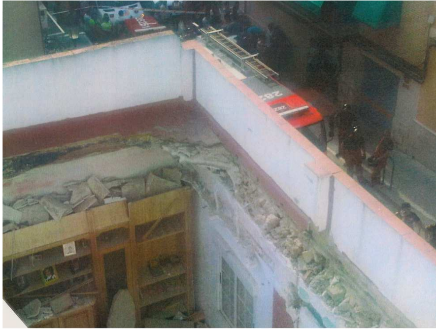
Fig. 4. Situación a la llegada de bomberos.2011. Expte. de ruina 7/2011 del archivo del Ayuntamiento de Paterna.
