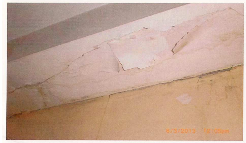
Fig. 19. Grieta en viga. 2013. Expte. 11/2013 Archivo del Ayuntamiento de Paterna.
