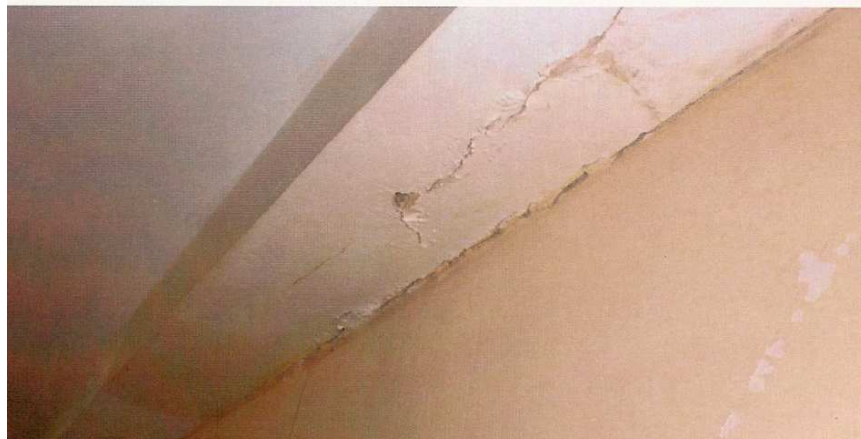
Fig. 20. Grieta en viga. 2013. Expte. 11/2013 Archivo del Ayuntamiento de Paterna.
