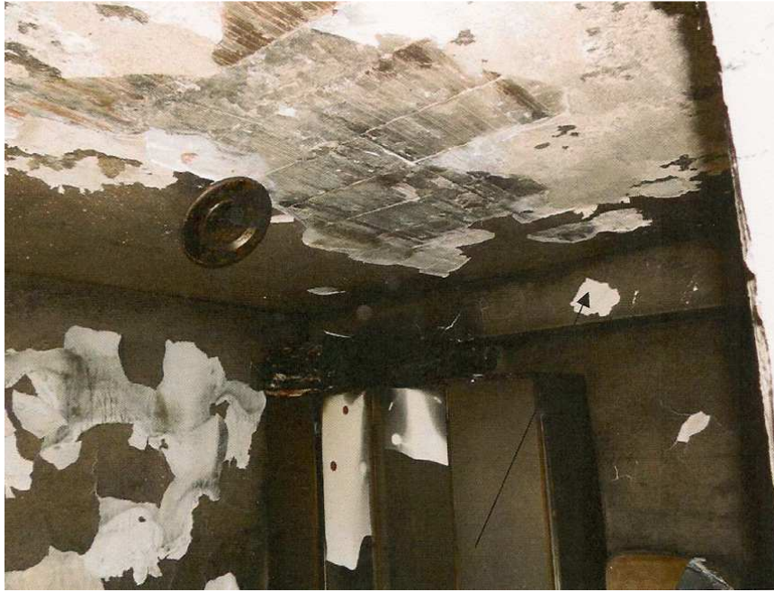
Fig. 11. Estado de la vivienda calcinada. 2012. Expte. de ruina nº 11/2012 del archivo del Ayuntamiento de Paterna.
