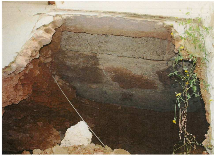
Fig. 30. Desprendimiento de techo de cueva. Se observa vegetación debido a la humedad existente en la roca que forma la bóveda de la cueva. 2012. Expte. 9/2012. Archivo del Ayuntamiento de Paterna.
