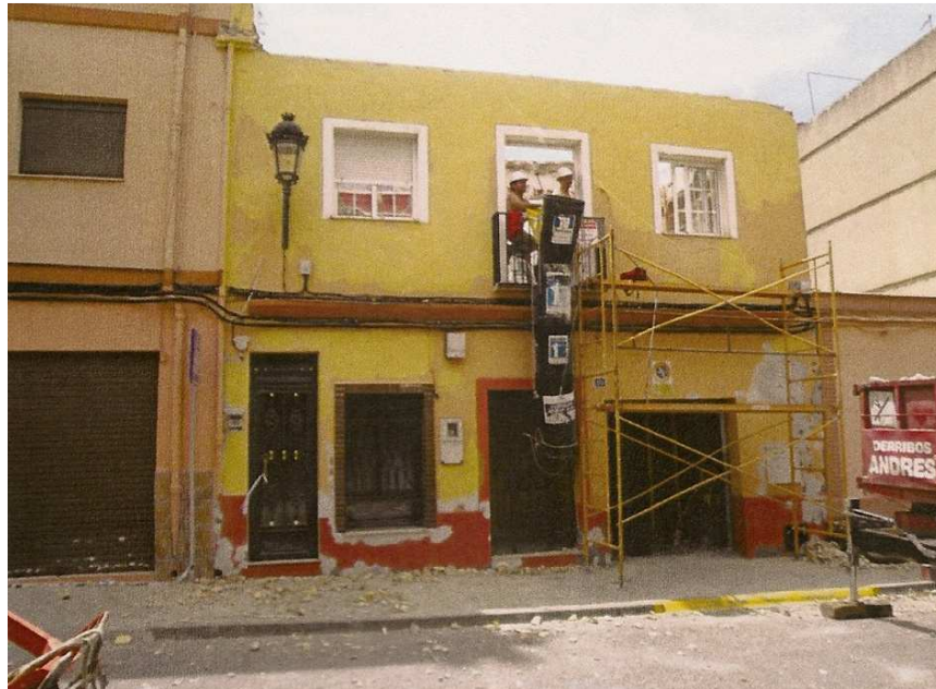
Fig. 7. Desescombro de planta 1ª. 2011. Expte. de ruina 7/2011 del archivo del Ayuntamiento de Paterna.
