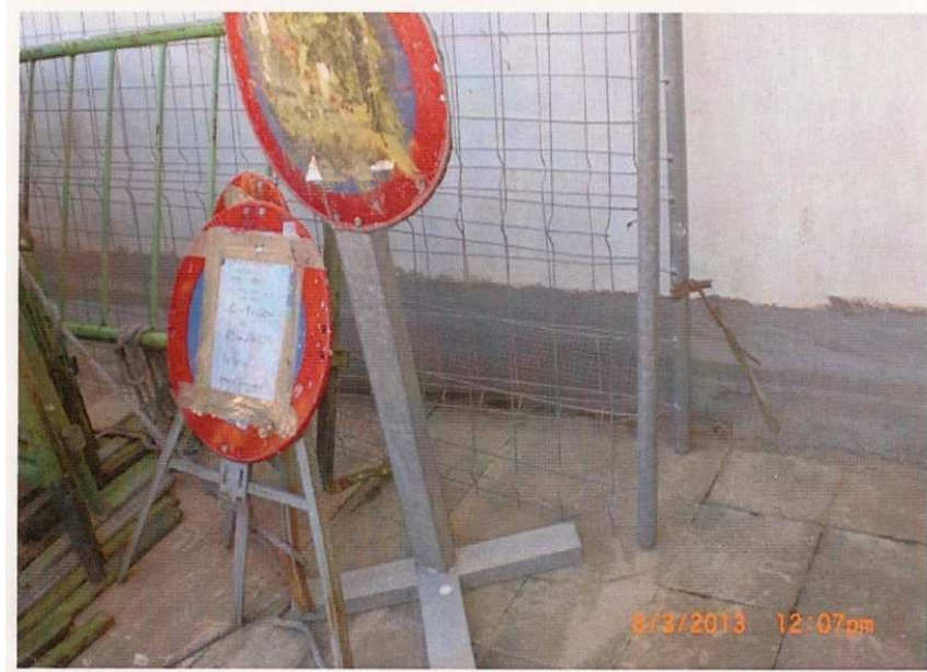
Fig. 17. Acopio de enseres varios en la cubierta. 2013. Expte. 11/2013 Archivo del Ayuntamiento de Paterna.
