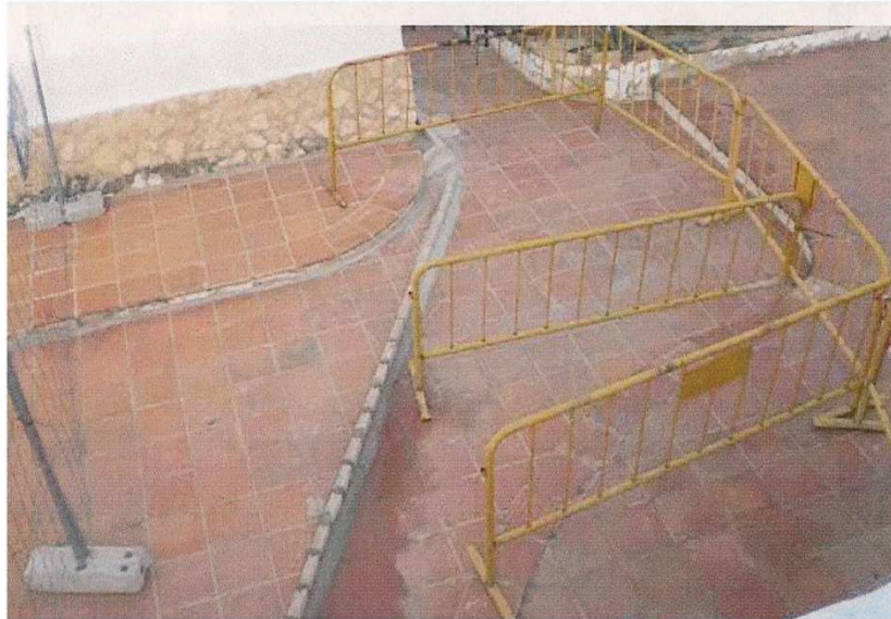
Fig. 36. Desvío de aguas pluviales para proteger las cuevas e inmuebles colindantes. 2012. Expte. 9/2012 Archivo del Ayuntamiento de Paterna.
