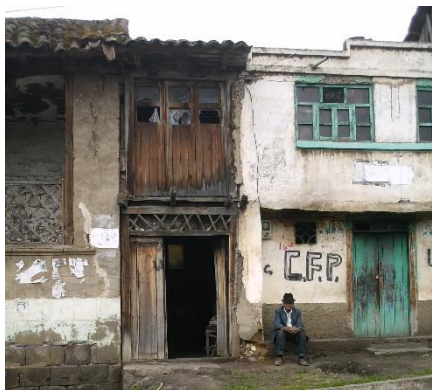
-Foto No7 Parroquia de Pilahuin, Provincia de Tungurahua. Falta de mantenimiento. Fuente: Propia 2010.
