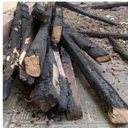
-Foto No.17 y 18 Colegio San Vicente de Paúl. Vigas de madera cortadas por los bomberos a pesar de que seguían funcionando, estructuralmente Fuente: Decreto de Emergencia del Patrimonio del Ecuador 2009
