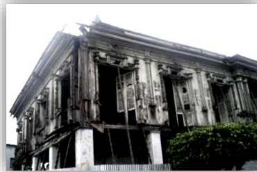
-Foto No.58. Antiguo Palacio Municipal de Vices, año 2008, después de 25 años de abandono.
