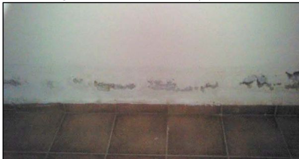
Figura 43 Muro analizado el día 29 de julio de 2014: humedad en base de muro
