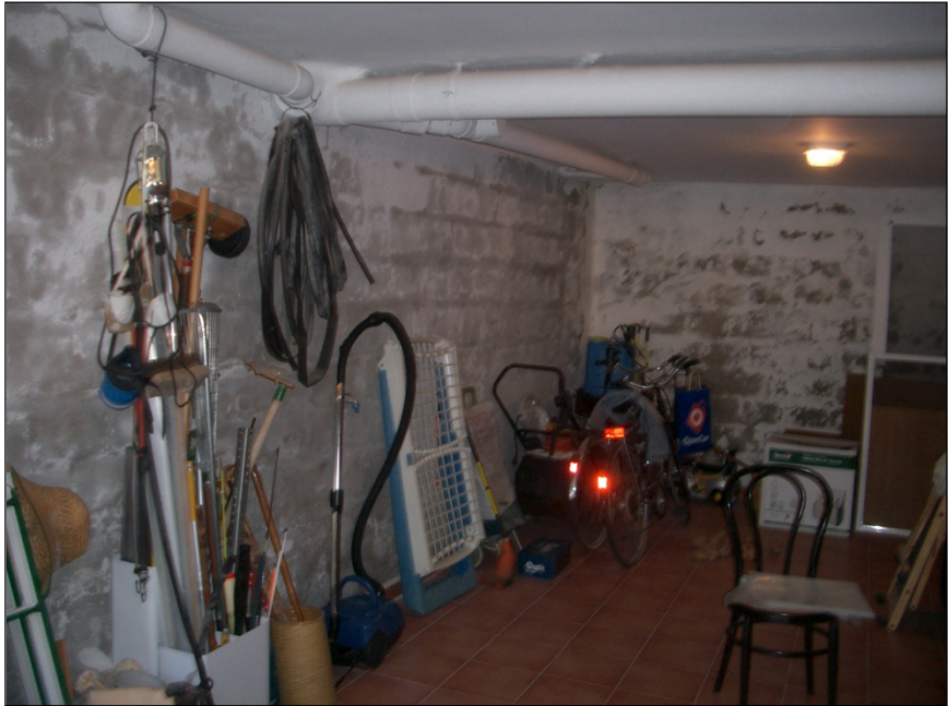
Figura 7 Muros semisótano en espacios habitados.
