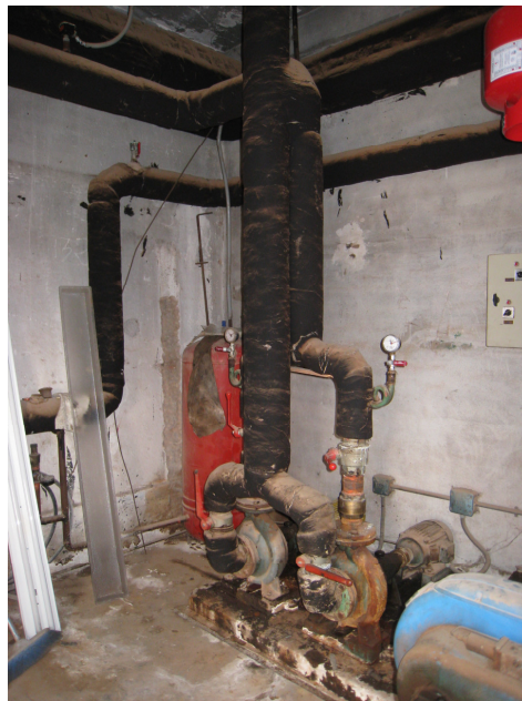
Figura 8: Cuarto de calderas. Fuente: propia
