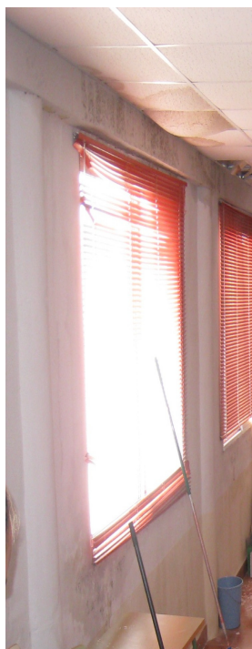
Figura 17: Fotografía en la que se pueden apreciar manchas de humedad así como la inexistencia de persianas. Fuente: propia
