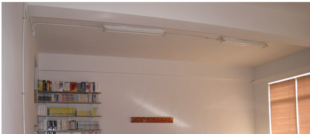
Figura 21: Luminarias existentes. Fuente: propia
