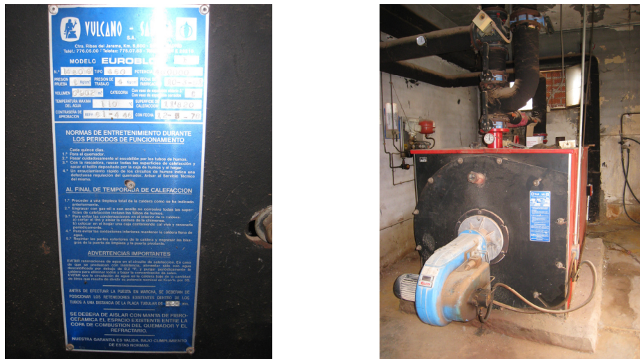
Figura 20: Imágenes de la chapa de la caldera y caldera Vulcano-Sadeca, Modelo Eurobloc f.Fuente: propia
