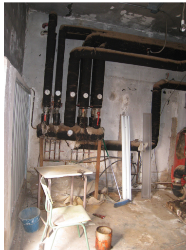
Figura 12: Imagen partición interior del cuarto calderas. Fuente: propia
