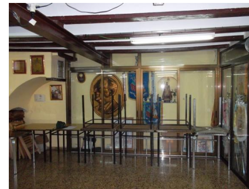
Pandeo correas. Forjado Planta Baja.
