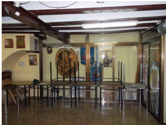
Pandeo correas. Forjado Planta Baja.
