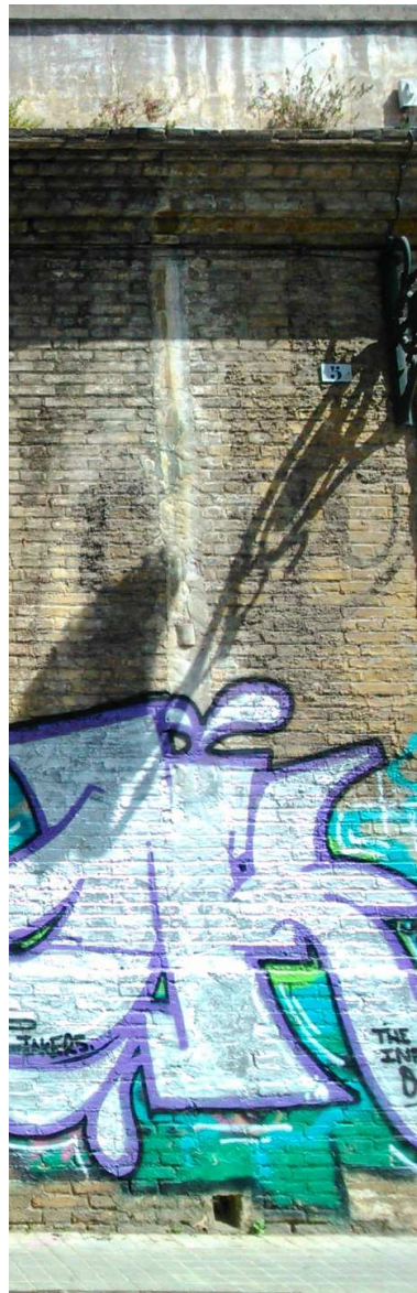
Ilustración.76. Descomposición del ladrillo caravista por erosión química. Fuente: Edición propia
