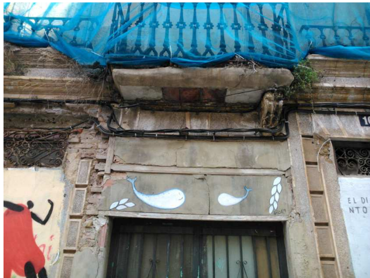
Ilustración.72. Desprendimientos de chapados. Fuente: Edición propia
