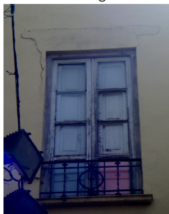
Ilustración.68. Fisura muerta dibujando el dintel.
