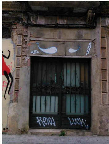
Ilustración.67. Grieta en dintel por acción mecánica.
