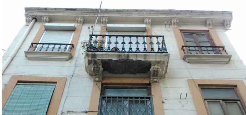
Ilustración.70. Desprendimiento de enfoscado bajo balcón.
