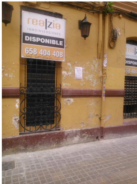
Ilustración.71. Desprendimiento de pintura en pared y en elemento metálico. Fuente: Edición propia
