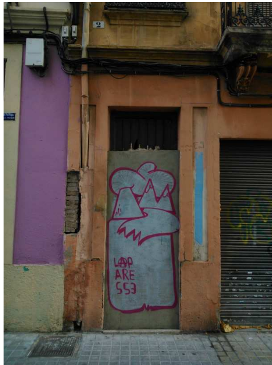
Ilustración.64. Humedad accidental. Fuente: Edición propia
