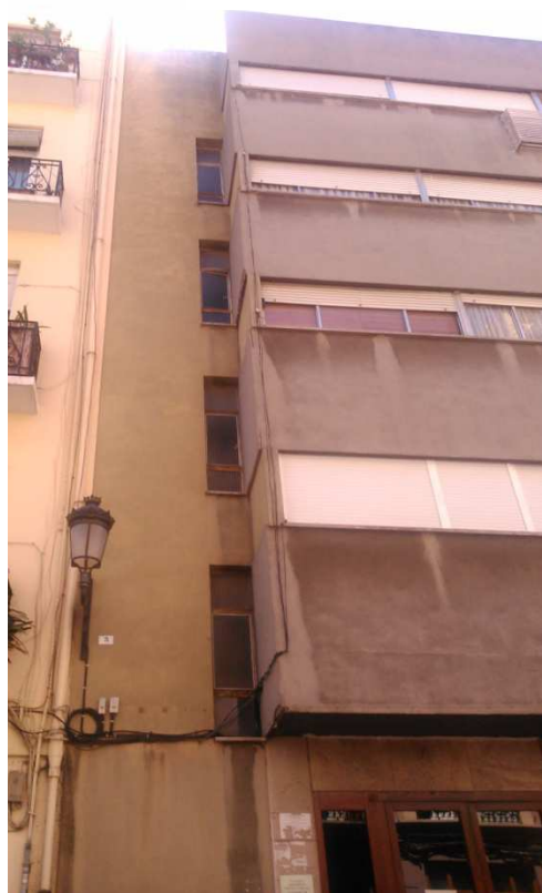
Ilustración.63. Humedades de filtración en fachadas. Fuente: Edición propia
