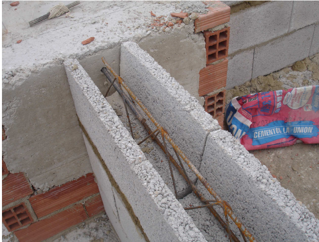
Foto 10. Unión enano de hormigón, y murete. 2014. Fuente: Elaboración propia.
