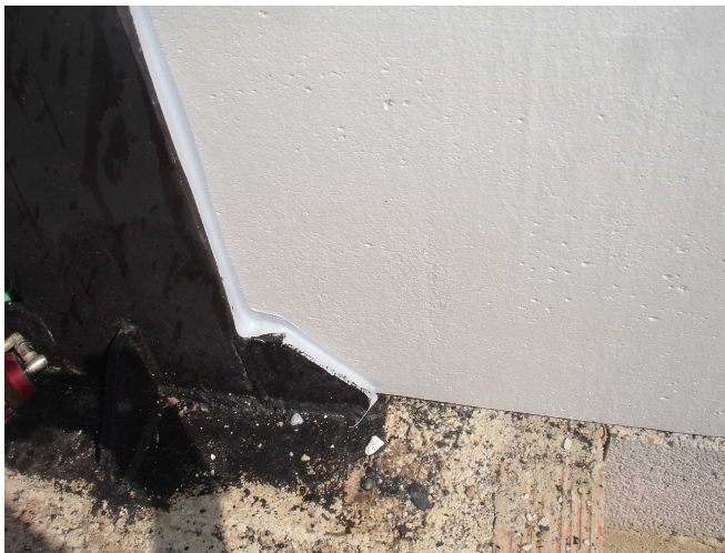
Foto 16. Rejuntado. 2014. Fuente: Elaboración propia.
