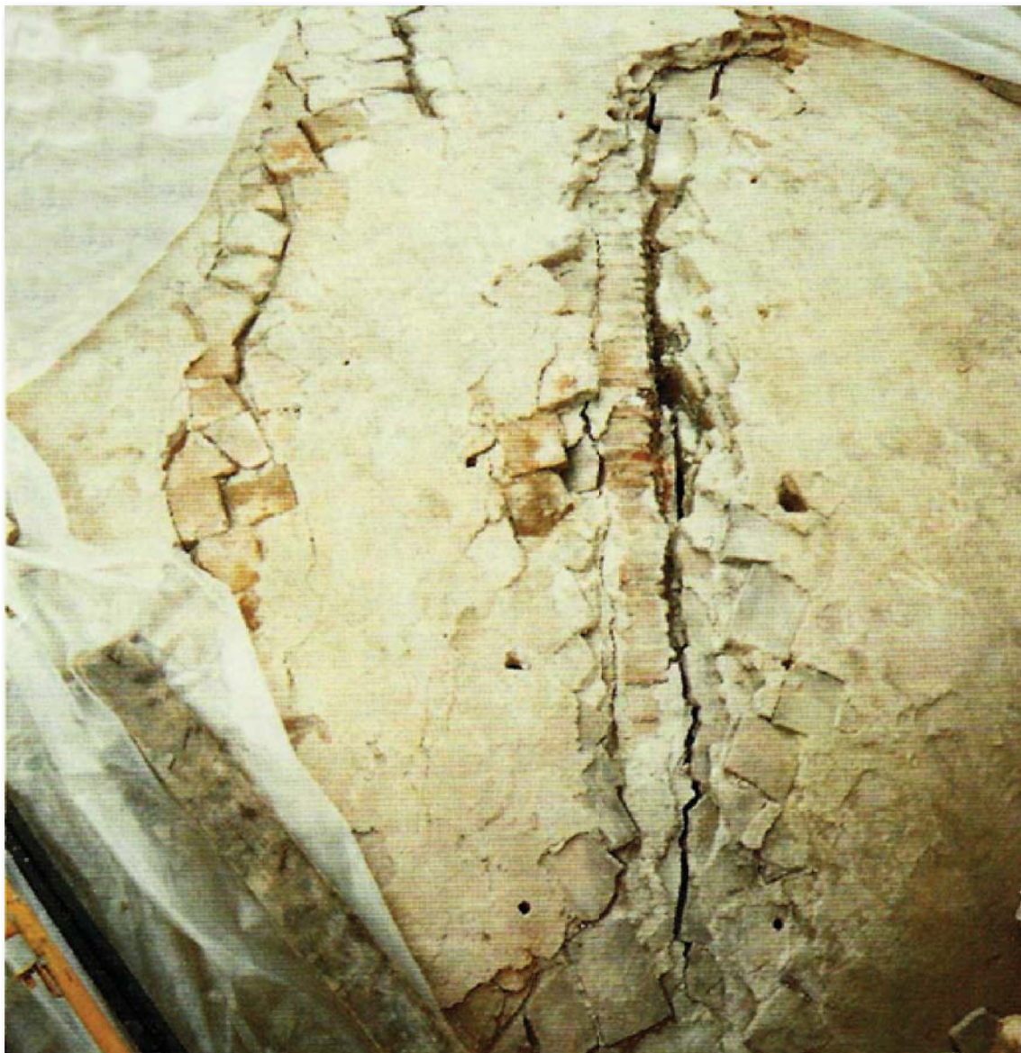
Fig. 15 Grietas en las bóvedas tanto en nervios como en plementerías. (Foto: cuadernillo de restauración)
