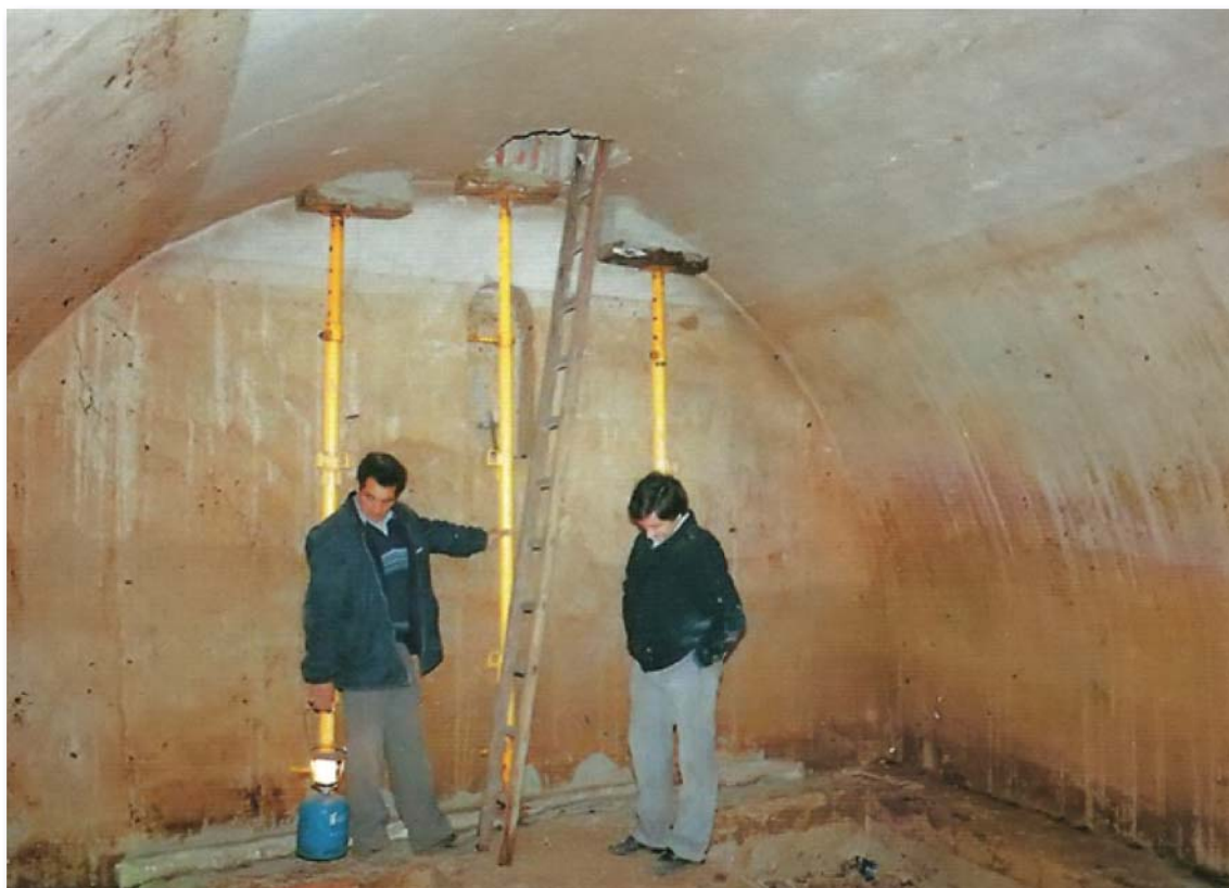
Fig. 14 Cripta bajo la capilla de la Anunciación. Se observa el nivel al cual llegó la acumulación de agua por rotura de una tubería (Foto: cuadernillo de restauración)
