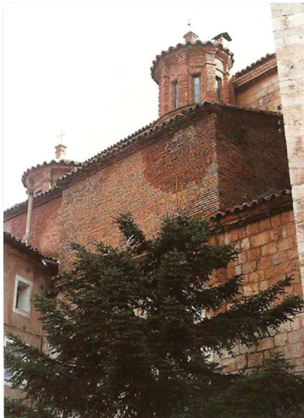
Fig. 17 Humedades en las cubiertas de las naves laterales (Foto: cuadernillo de restauración)
