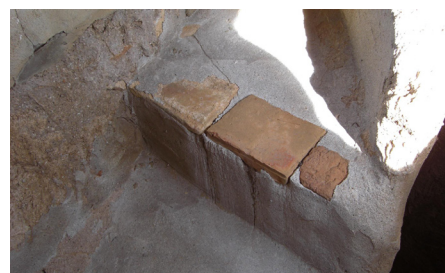
Pèrdua del revestiment
