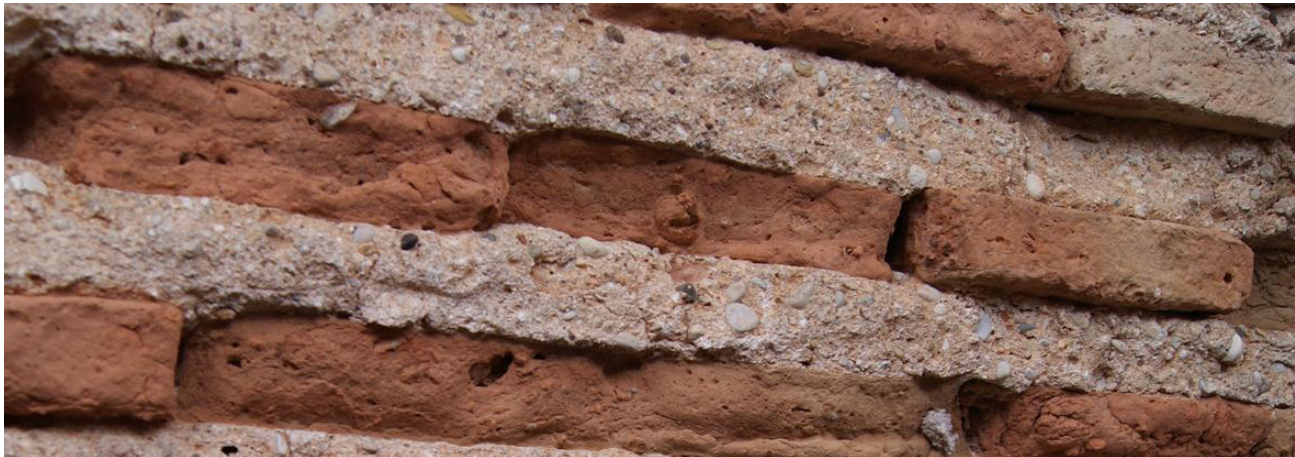
Disgregació dels rajols
