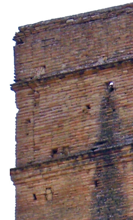
Despreniments en la fàbrica de rajola. Façana Oest
