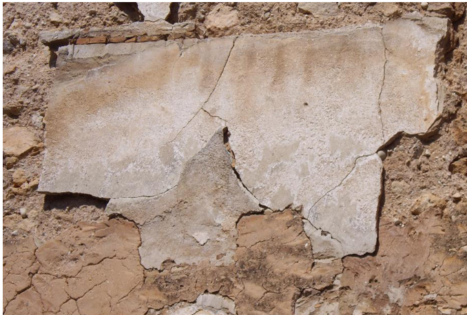
Fissures dels revestiments. Façana Sud, cota +15m
