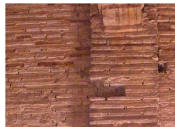
Despreniments per travesa deficient
