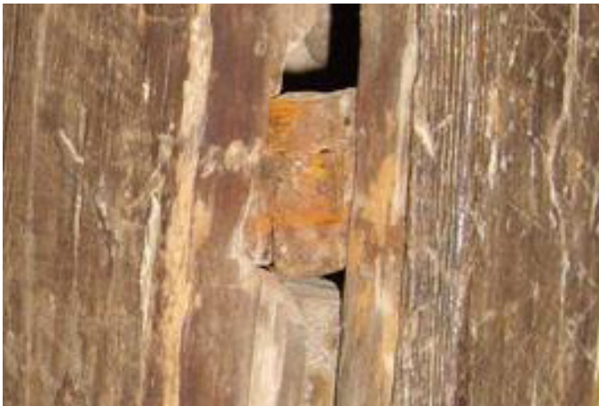
Oxidació en les frontisses de la porta de l'escala, en la planta segona
