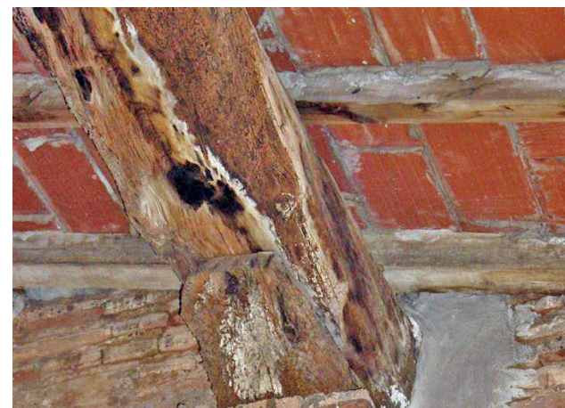
Putrefacció blanca en la biga de la coberta, cap de la biga en orientació Sud
