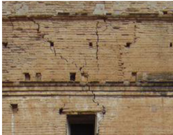
Esquerdes en la façana Sud, finestra de la tercera planta
