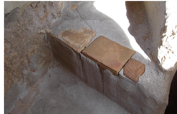
Erosió mecànica per fregament en els últims graons de l'escala cap a la coberta, cota +24m
