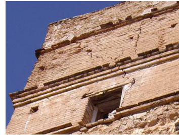
Despreniments, esquerdes, desplom i fletxa
