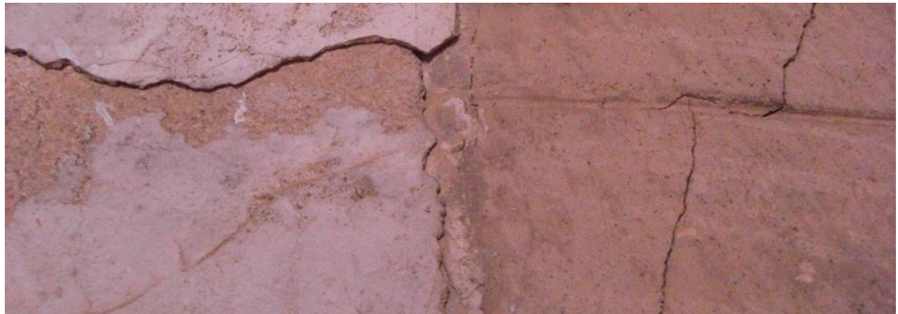
Mostra de diferents revestiments superposats en el mur interior Est de la planta segona
