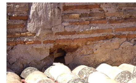
Intervenció. Desguàs deficient
