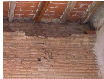
Despreniments, rejunrats, esquerdes
