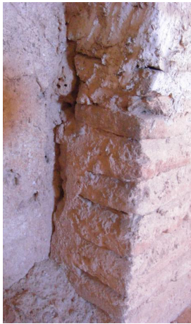
Embrutiment per dipòsit. Acumulació de pols en la planta tercera
