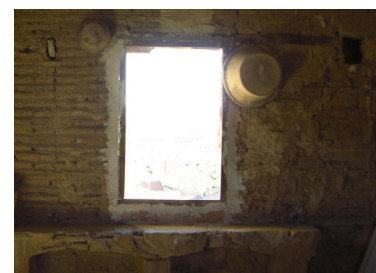
Deficiència en la instal·lació
