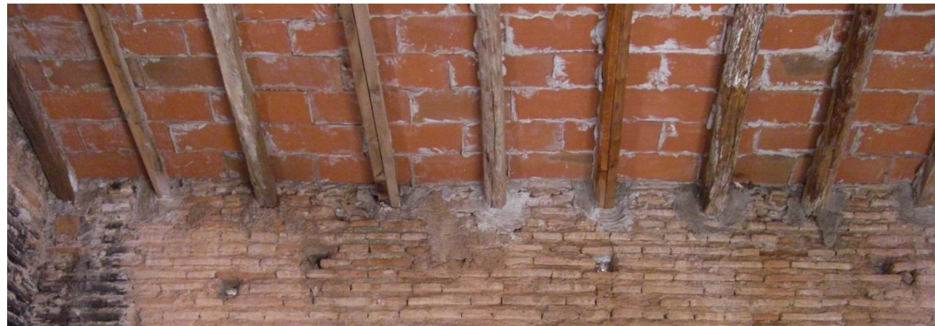
Reposició d'algunes biguetes de la coberta. Vista del mur Oest
