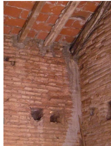
Humitat, disgregació, rejuntats
