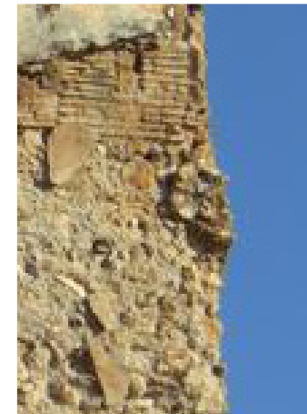
Despreniments en la tàpia i de revestiments. Façana Sud, cota +17m
