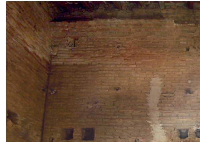
Eflorescències en la fàbrica per aportació d'aigua de pluja en la planta tercera, mur Est
