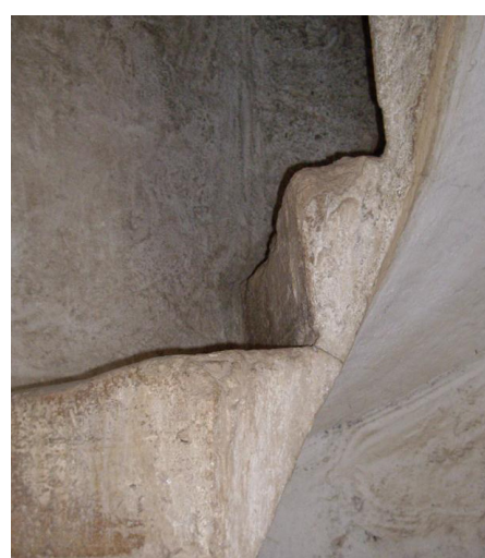
Fissures en punts febles
