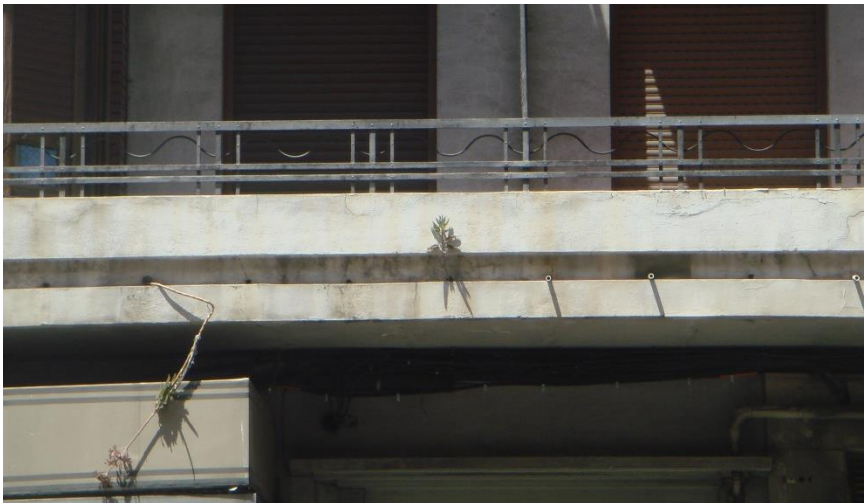
Figura 43. Fisuras en frente de voladizo.2014. Fuente propia.
