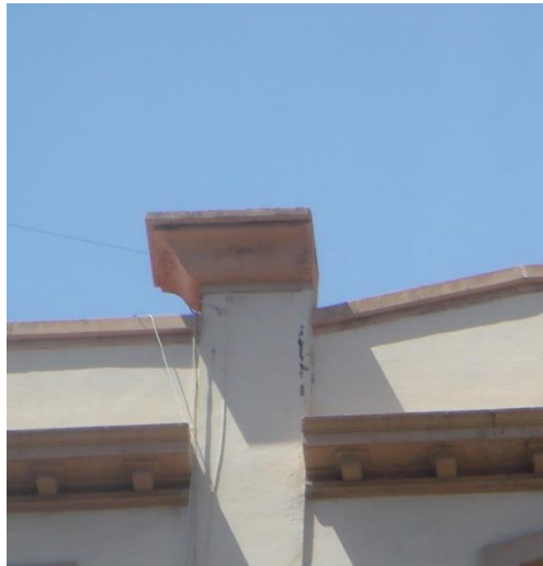
Figura 42. Grieta en antepecho de cubierta.2014. Fuente propia.
