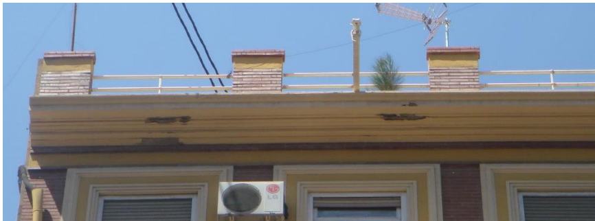
Figura 41. Bordes erosionados en cornisa.2014. Fuente propia.
