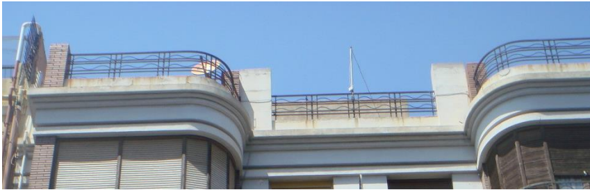
Figura 46. Oxidación en barandilla de cubierta.2014. Fuente propia.
