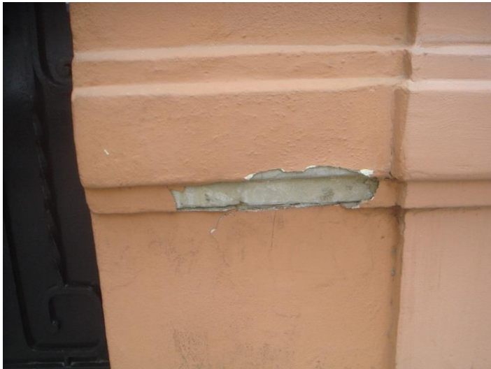
Figura 44. Desprendimiento de acabado continuo.2014. Fuente propia.
