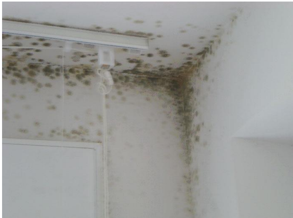
Figura 39. Humedad por condensación. 2014. Fuente propia.
