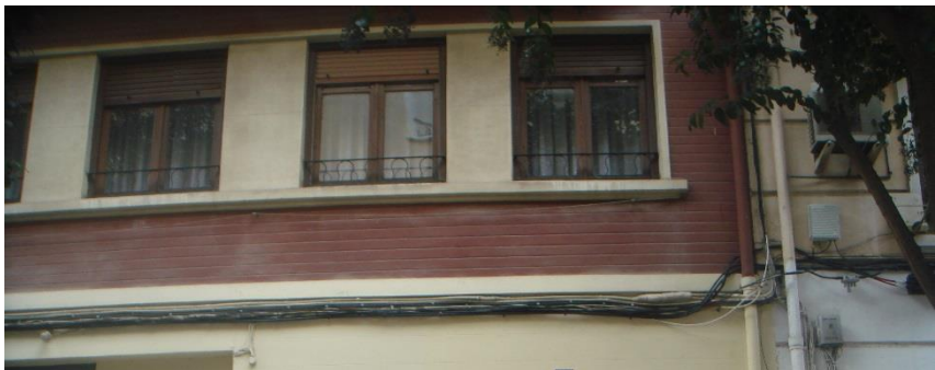
Figura 45. Eflorescencia en ladrillo caravista.2014. Fuente propia.
