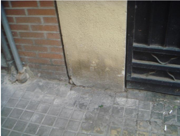
Figura 47. Arranque de fachada afectada por nitratos. 2014. Fuente propia.
