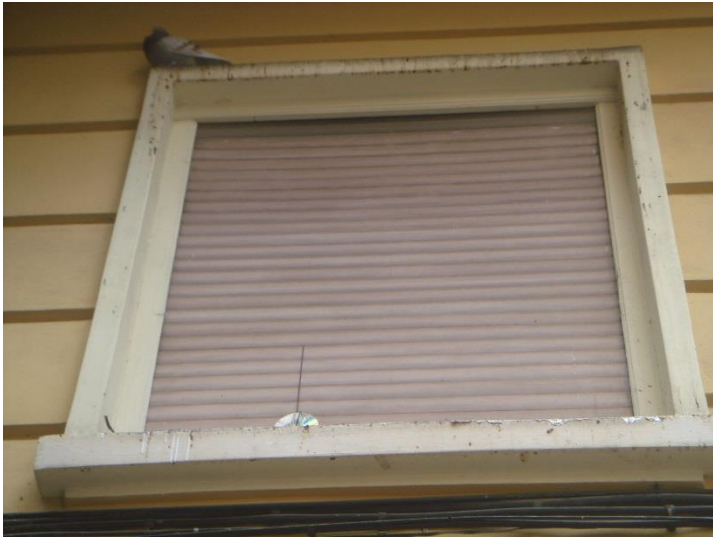
Figura 48. Erosión química por depósitos de aves.2014. Fuente propia.
