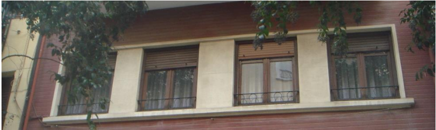
Figura 33. Ejemplo encuentro de fachada con carpintería .2014. Fuente propia.
