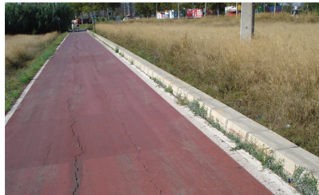
Fig. C5.123 Firme en mal estado de la Vía Xurra Elaboración propia
