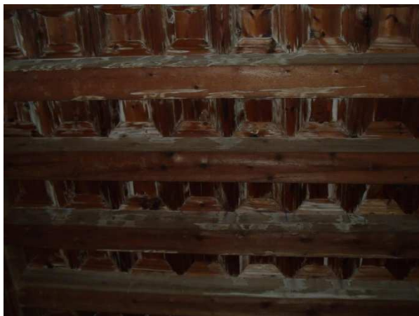
Figura 123. Humedad y suciedad en artesonado. Sala de Armas. Mayo 2014. Fotografía particular.
