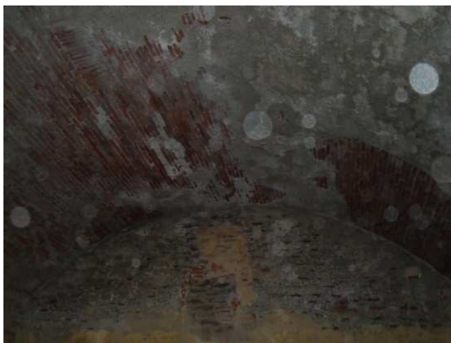
Figura 121. Presencia de humedad que provoca el desprendimiento del revestimiento y la apariencia de manchas y eflorescencias. Cocheras. Mayo 2014. Fotografía particular.
