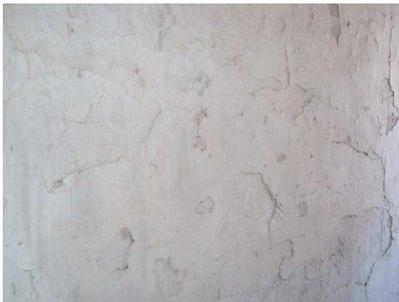
Figura 101. Desprendimiento del revestimiento causado por la humedad. Sala de los Marqueses. Mayo 2014. Fotografía particular.
