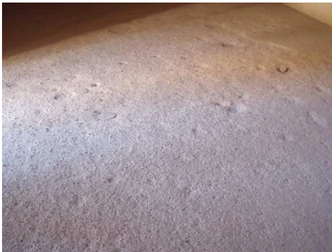
Figura 55. Falta total de solería. Sala de los Marqueses. Mayo 2014. Fotografía particular.
