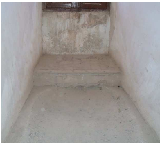
Figura 99. Humedad por falta de estanqueidad en ventana. Sala anexa a la Sala de la Justicia. Mayo 2014. Fotografía particular.
