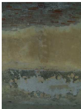
Figura 98. Humedad por capilaridad y condensación en paramento. Cocheras. Mayo 2014. Fotografía particular.
