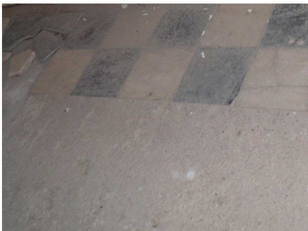
Figura 54. Rotura y falta de solería de mármol. Sala de la Justicia. Mayo 2014. Fotografía particular.
