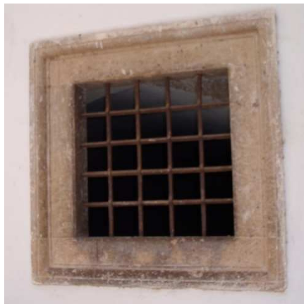
Figura 84. Manchas de pintura provocadas por la falta de limpieza a la hora de reparar el paramento. Decoración de piedra caliza en ventana del patio central. Mayo 2014. Fotografía particular.
