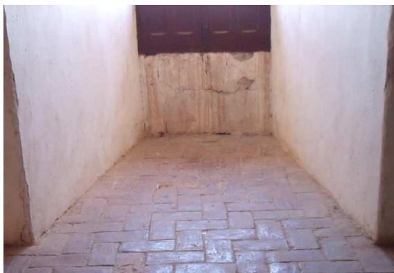
Figura 100. Humedad por falta de estanqueidad en ventana. Salón de Occidente. Mayo 2014. Fotografía particular.
