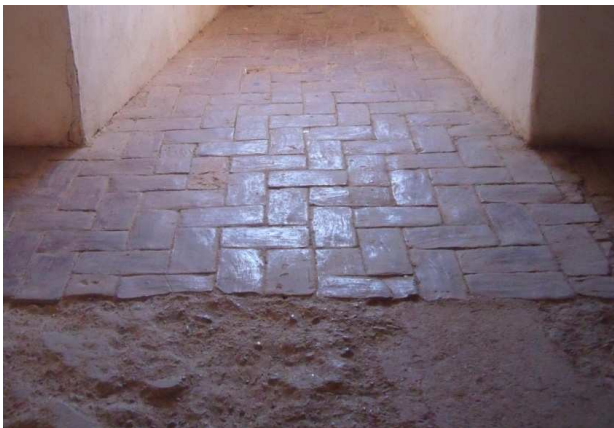
Figura 53. Falta de solería de barro cocido. Salón de Occidente. Mayo 2014. Fotografía particular.
