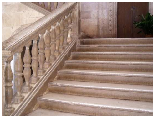
Figura 96. Suciedad en balaustrada y peldaños de mármol. Escalera de acceso a la planta primera. Mayo 2014. Fotografía particular.
