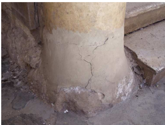
Figura 77. Pérdida de material de la base de piedra caliza. Parte inferior de la columna reconstruida con mortero reparador. Galería inferior del patio central. Mayo 2014. Fotografía particular.
