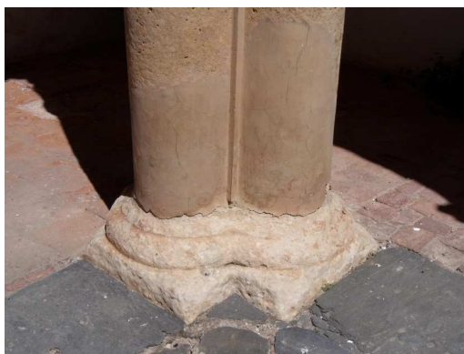
Figura 71. Desgaste de la base de piedra caliza. Parte inferior de la columna reconstruida con mortero reparador. Galería inferior del patio central. Mayo 2014. Fotografía particular.
