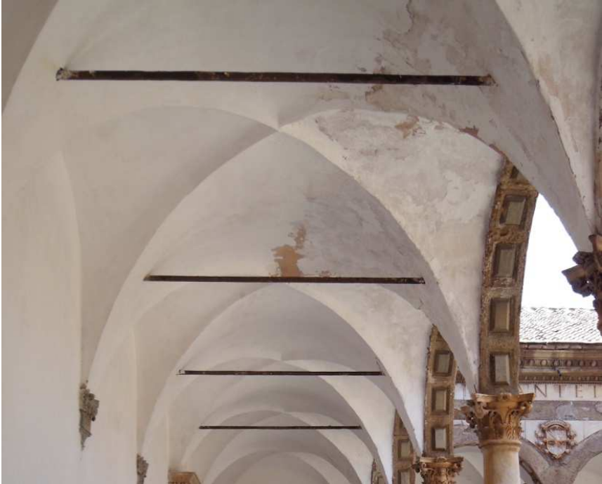
Figura 132. Humedad y oxidación en bóveda de arista. Galería superior del patio central. Junio 2014. Fotografía particular.
