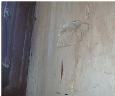
Figura 108. Suciedad y falta de material en el paramento causado por erosión humana. Salón de Occidente. Mayo 2014. Fotografía particular.
