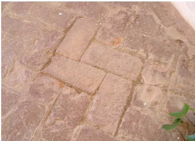
Figura 58. Falta de fragua en las llagas de solería de barro cocido. Distribuidor superior de la escalera de acceso a la planta primera. Mayo 2014. Fotografía particular.
