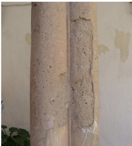
Figura 63. Pérdida de material de una columna de piedra caliza. Galería inferior del patio central. Mayo 2014. Fotografía particular.
