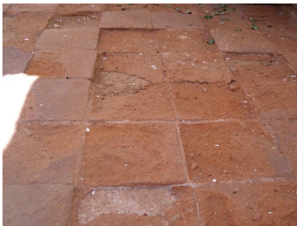
Figura 46. Exfoliación y meteorización en solería de barro cocido. Galería inferior del patio central. Mayo 2014. Fotografía particular.
