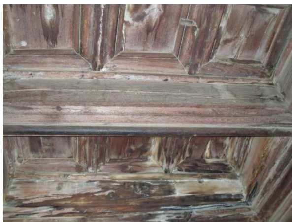
Figura 129. Humedad en artesanado. Dependencias del servicio. Junio 2014. Fotografía particular.
