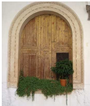
Figura 88. Exceso de vegetación y humedad en alfeizar de ventana. Sala de Armas. Mayo 2014. Fotografía particular.
