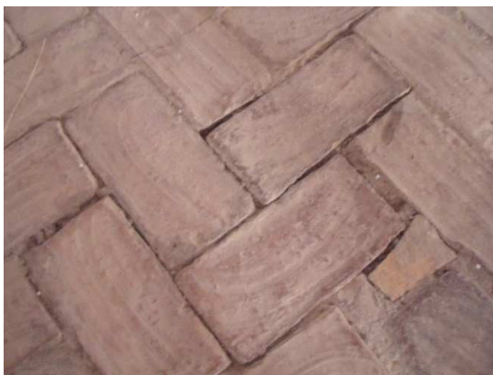
Figura 57. Falta de fragua en las llagas de solería de barro cocido. Sala del Cuerpo de Guardia. Mayo 2014. Fotografía particular.
