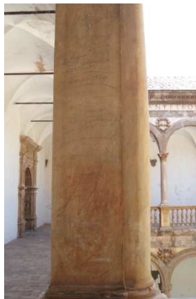
Figura 69. Suciedad y pintadas en columnas de mármol. Galería superior del patio central. Mayo 2014. Fotografía particular.
