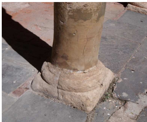
Figura 75. Desgaste de la base de piedra caliza. Parte inferior de la columna reconstruida con mortero reparador. Galería inferior del patio central. Mayo 2014. Fotografía particular.
