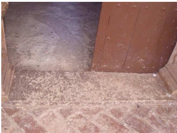
Figura 52. Desgaste del umbral de piedra y falta de solería. Salón de Occidente. Mayo 2014. Fotografía particular.
