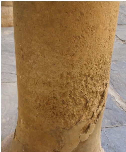
Figura 64. Pérdida de material de una columna de piedra caliza. Galería inferior del patio central. Mayo 2014. Fotografía particular.
