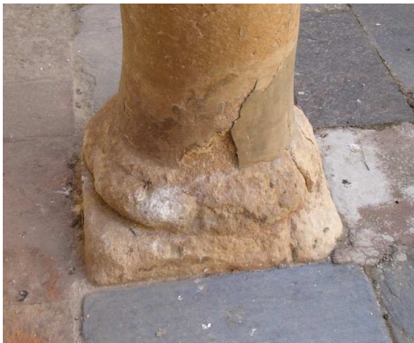
Figura 72. Rotura de la base de piedra caliza. Parte inferior de la columna reconstruida con mortero reparador. Galería inferior del patio central. Mayo 2014. Fotografía particular.
