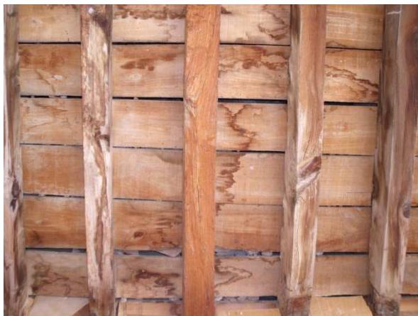
Figura 128. Humedad en techo de madera. Pasillo de acceso a la planta intermedia. Junio 2014. Fotografía particular.
