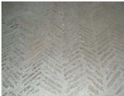
Figura 44. Suciedad en solería de barro cocido. Cocheras. Mayo 2014. Fotografía particular.
