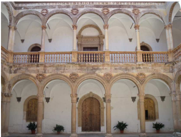
Figura 65. Suciedad generalizada en la portada sur del patio central. Mayo 2014. Fotografía particular.
