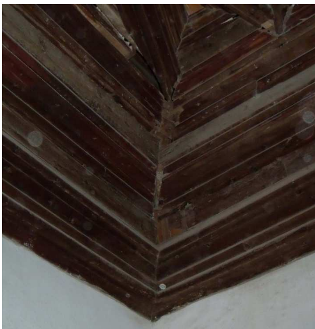
Figura 113. Suciedad y falta de traba en las piezas del artesanado. Sala situada entre la Sala de la Justicia y la Sala de los Marqueses. Mayo 2014. Fotografía particular.
