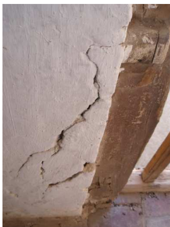
Figura 109. Rotura del paramento dejando en libertad la sujeción de la barandilla. Pasillo de acceso a planta intermedia. Junio 2014. Fotografía particular.
