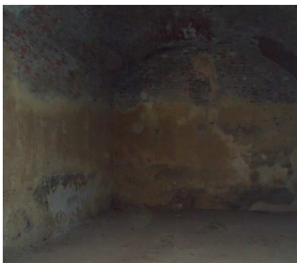
Figura 97. Humedad por capilaridad y condensación en paramento y techo de las Cocheras. Planta Baja. Mayo 2014. Fotografía particular.
