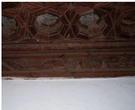
Figura 118. Suciedad, manchas de pintura y falta de piezas en artesanado. Sala de acceso a la planta intermedia. Junio 2014. Fotografía particular.
