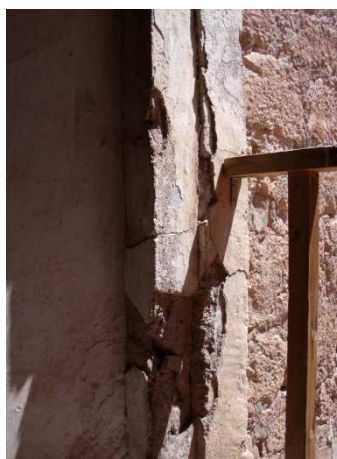
Figura 110. Rotura del paramento dejando en libertad la sujeción de la barandilla. Distribuidor de escalera en planta primera. Junio 2014. Fotografía particular.
