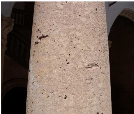
Figura 62. Pérdida de material de una columna de piedra caliza. Galería inferior del patio central. Mayo 2014. Fotografía particular.
