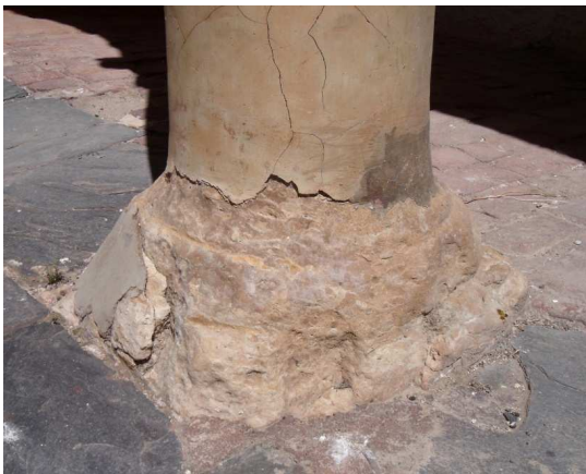
Figura 76. Rotura de la base de piedra caliza. Parte inferior de la columna reconstruida con mortero reparador. Galería inferior del patio central. Mayo 2014. Fotografía particular.
