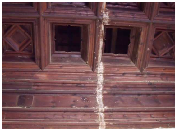
Figura 114. Falta de piezas en artesanado y suciedad provocada por la eliminación de un tabique divisorio. Sala de la Justicia. Mayo 2014. Fotografía particular.
