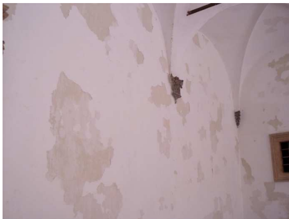
Figura 102. Desprendimiento del revestimiento causado por la humedad. Distribuidor de escalera en planta primera. Mayo 2014. Fotografía particular.
