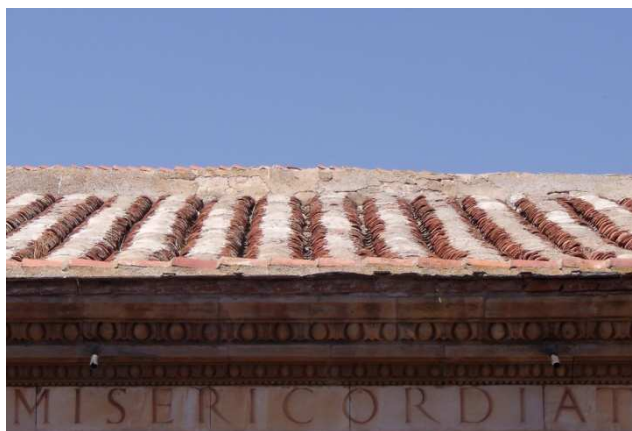
Figura 131. Cubierta de teja cerámica curva reparada, donde se pueden observar hiladas de mortero entre las tejas, para evitar su levantamiento con el viento. Cubierta de la escalera de acceso a la planta primera. Junio 2014. Fotografía particular.
