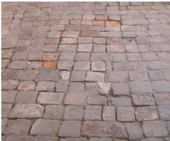
Figura 56. Falta de piezas y fragua en las llagas de solería de barro cocido. Galería inferior del patio central. Mayo 2014. Fotografía particular.
