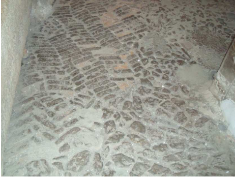
Figura 42. Desgaste y falta de piezas de solería de adoquines de piedra. Galería de entrada. Mayo 2014. Fotografía particular.
