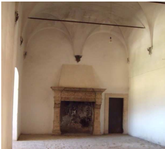
Figura 126. Suciedad en el techo provocada por el uso de la chimenea. Salón de Occidente. Mayo 2014. Fotografía particular.
