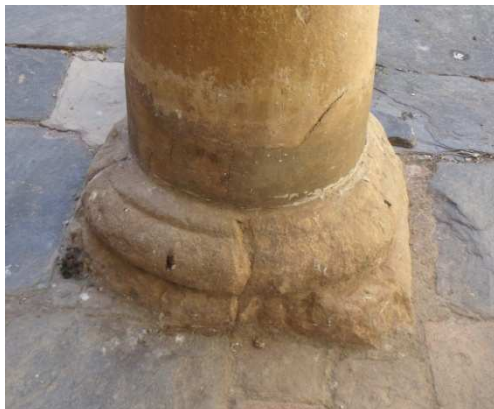
Figura 74. Desgaste de la base de piedra caliza. Parte inferior de la columna reconstruida con mortero reparador. Galería inferior del patio central. Mayo 2014. Fotografía particular.
