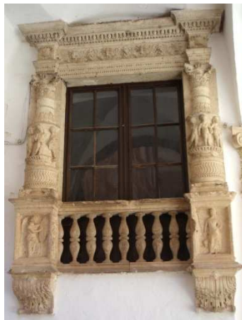
Figura 90. Suciedad y rotura de piezas en decoración de ventana de piedra caliza. Dependencias no accesibles del nivel intermedio. Mayo 2014. Fotografía particular.
