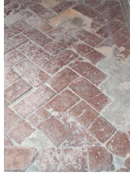
Figura 43. Rotura y falta de piezas en solería de barro cocido. Meseta de escalera de acceso al patio central. Mayo 2014. Fotografía particular.
