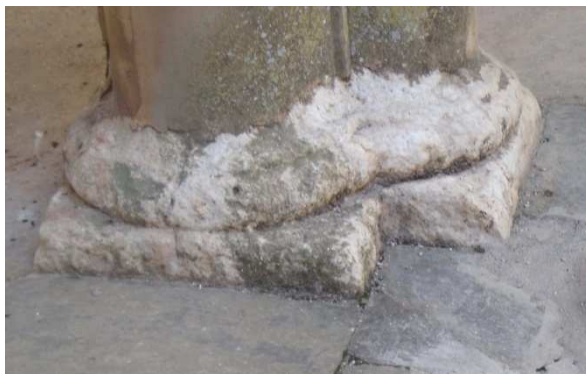
Figura 73. Suciedad y humedad de la base de piedra caliza. Galería inferior del patio central. Mayo 2014. Fotografía particular.
