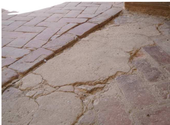
Figura 51. Falta de solería de barro cocido entre el distribuidor superior de la escalera y la galería superior del patio central. Mayo 2014. Fotografía particular.
