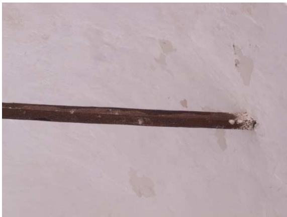
Figura 124. Oxidación de los tirantes de hierro de una bóveda de arista. Galería inferior del patio central. Mayo 2014. Fotografía particular.
