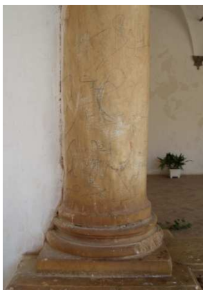
Figura 70. Suciedad y pintadas en columnas de mármol. Galería superior del patio central. Mayo 2014. Fotografía particular.
