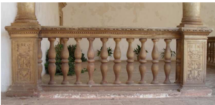
Figura 66. Suciedad en balaustrada de mármol. Galería superior del patio central. Mayo 2014. Fotografía particular.
