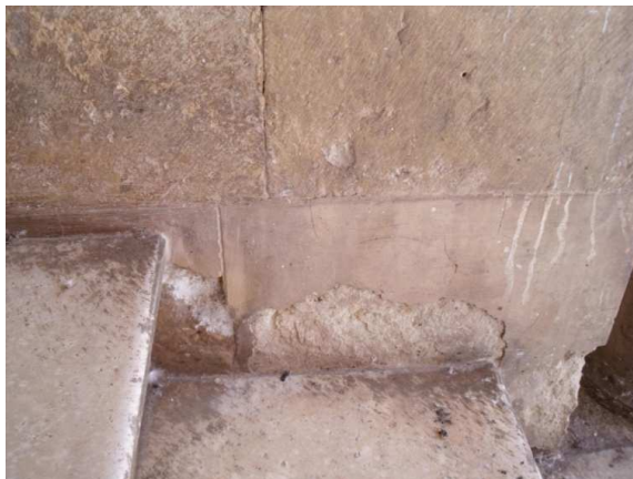
Figura 103. Desprendimiento de revestimiento escalera de acceso a planta primera, aplicado a posteriori para reconstruir el desgaste de la piedra que forma el zanquín. Junio 2014. Fotografía particular.
