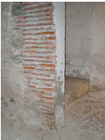
Figura 105. Desprendimiento de revestimiento. Cocheras. Planta Baja. Mayo 2014. Fotografía particular.
