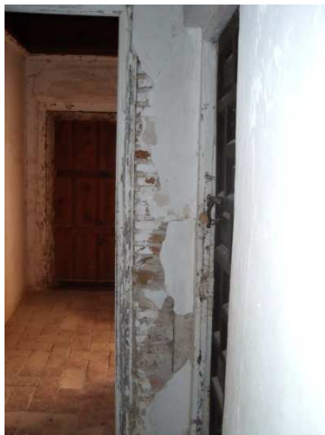
Figura 106. Desprendimiento de revestimiento. Sala de acceso a bajada a planta intermedia. Fotografía particular.
