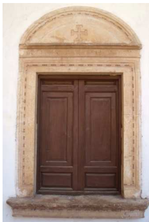
Figura 95. Suciedad y manchas de pintura en decoración de piedra caliza. Ventana anexa al la Sala de los Marqueses. Junio 2014. Fotografía particular.
