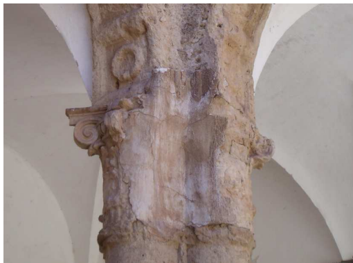
Figura 78. Rotura del capitel de piedra caliza. Galería inferior del patio central. Mayo 2014. Fotografía particular.
