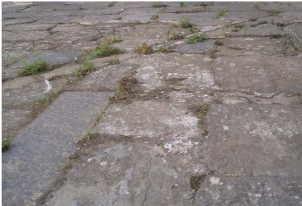
Figura 60. Vegetación en solería de baldosas de piedra. Patio central. Mayo 2014. Fotografía particular.
