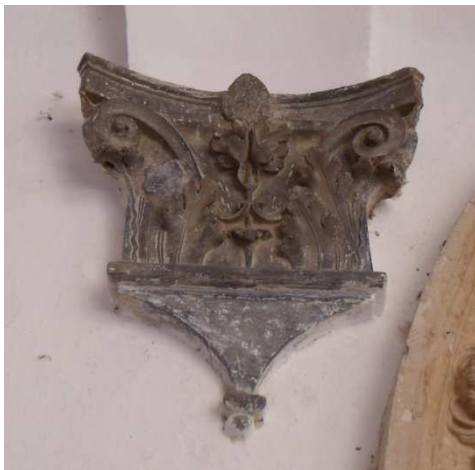
Figura 92. Suciedad y manchas de pintura en decoración de piedra. Apoyo de los arcos de la bóveda de arista de la Galería inferior del patio central. Mayo 2014. Fotografía particular.
