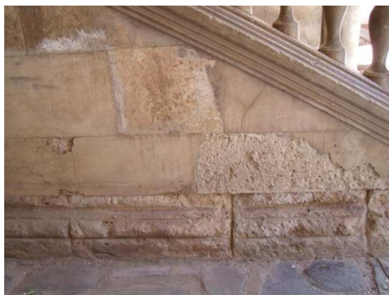
Figura 104. Desprendimiento de revestimiento escalera de acceso a planta primera, aplicado a posteriori para reconstruir el desgaste de la piedra. Junio 2014. Fotografía particular.
