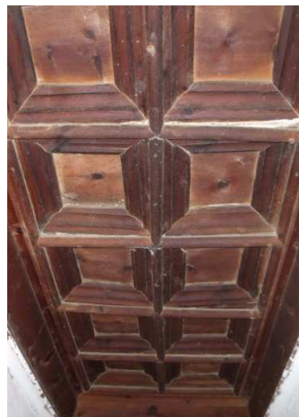
Figura 117. Suciedad, humedad y desprendimiento de piezas en artesanado. Pasillo interior de acceso a la planta intermedia. Junio 2014. Fotografía particular.
