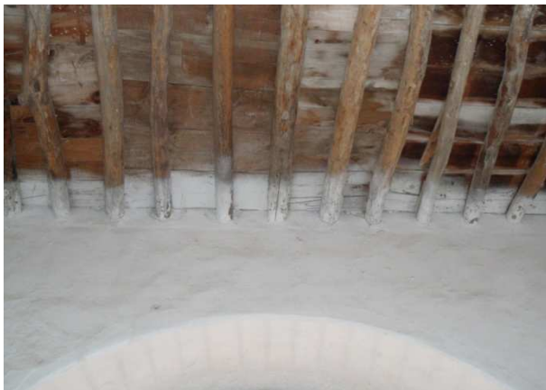
Figura 122. Manchas de pintura en el techo, debido a la falta de precisión en la realización de los trabajos de mantenimiento. Sala de acceso a las Cocheras. Mayo 2014. Fotografía particular.
