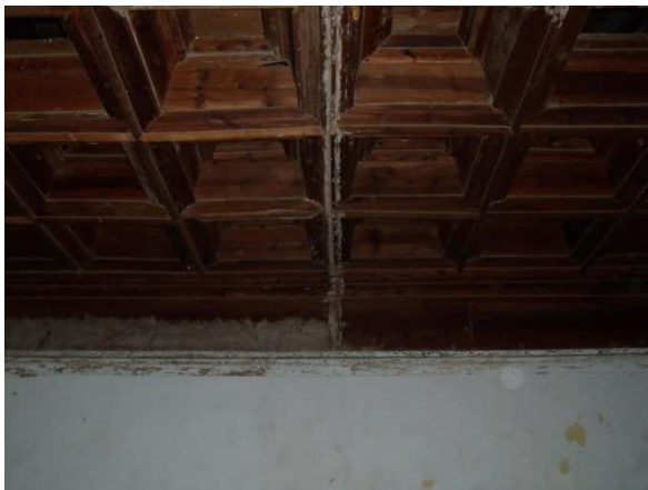
Figura 119. Falta de piezas en artesanado y suciedad provocada por la eliminación de un tabique divisorio. Sala en planta primera. Junio 2014. Fotografía particular.
