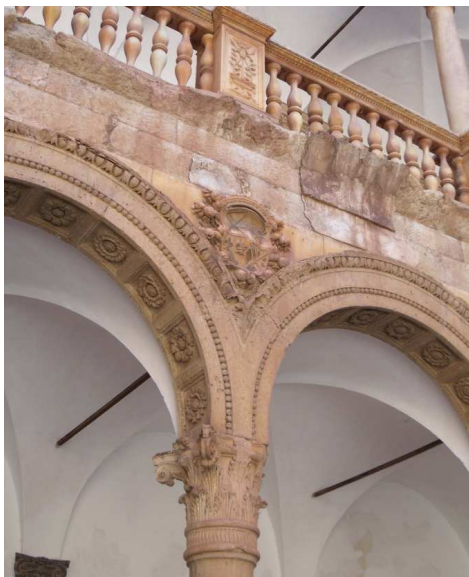
Figura 82. Desprendimiento del friso de la planta superior, que al caer golpea y rompe las molduras de los arcos y los capiteles de las columnas. Patio central. Mayo 2014. Fotografía particular.
