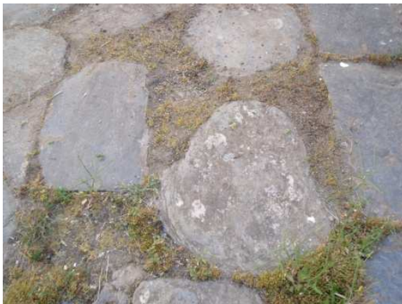
Figura 61. Vegetación en solería de baldosas de piedra. Patio central. Mayo 2014. Fotografía particular.
