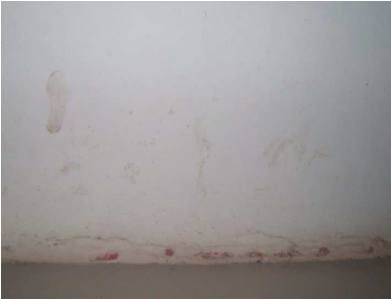
Figura 112. Desprendimiento de revestimiento en la zona del rodapié y suciedad en el paramento ocasionada intencionadamente. Mayo 2014. Sala de la Justicia. Fotografía particular.
