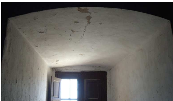
Figura 127. Desprendimiento del revestimiento provocado por humedad por condensado en el techo de la ventana. Mayo 2014. Fotografía particular.
