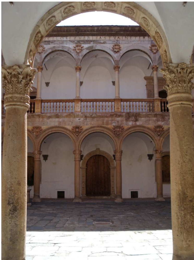
Figura 67. Al frente suciedad en las columnas de piedra caliza de la galería inferior del patio central. Al fondo suciedad las columnas, friso y balaustrada de la portada este del patio central. Mayo 2014. Fotoarafia particular.
