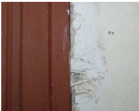
Figura 107. Desprendimiento de revestimiento que muestra las garras de sujeción de una puerta. Sala de la Justicia. Mayo 2014. Fotografía particular.
