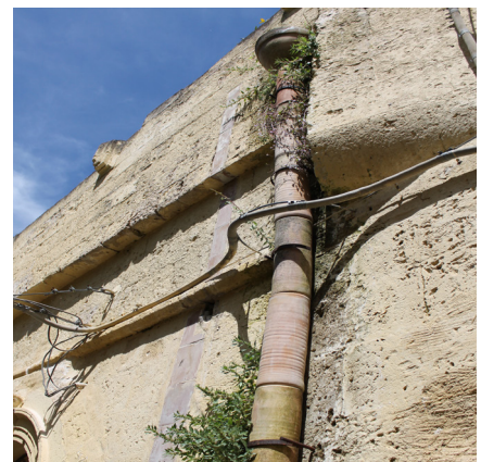
Figura 59, bajante de aguas pluviales(2014). Fuente: Imagen de autor
