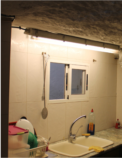
Figura 118, ventana que comunica la cocina con el lucernario del patio de luces (2014). Fuente: imagen de autor.
