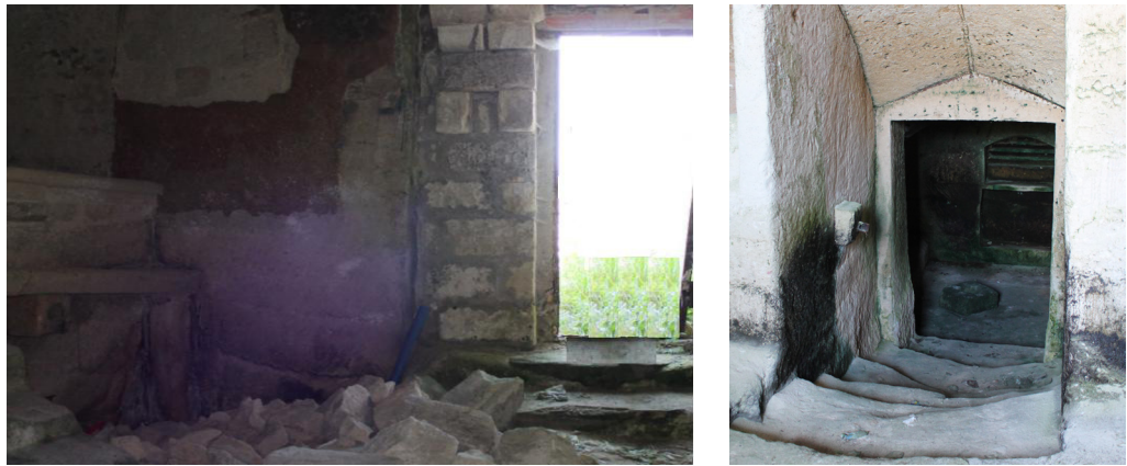
Figuras 96 y 97. Desniveles interiores existentes en el interior de la cueva del caso práctico 2. (2014) Fuente: imagen de autor.
