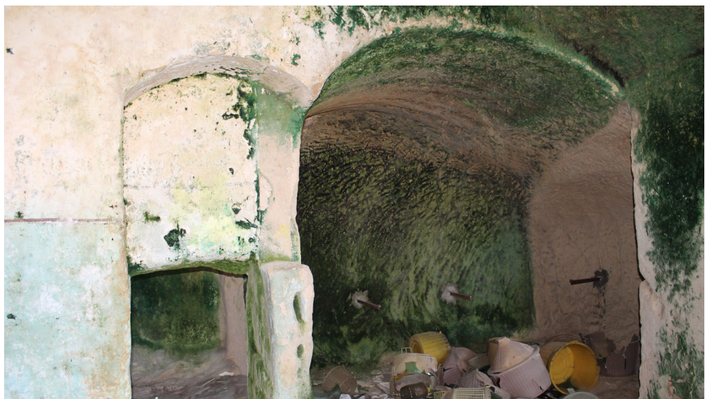
Figura 124, paredes y techo con moho en una cueva del Sasso Caveoso (2014). Fuente: imagen de autor
