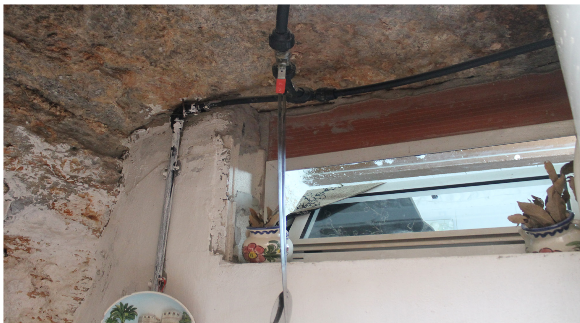
Figura 96, ventana que comunica el baño con el lucernario del corral (2014). Fuente: imagen de autor.
