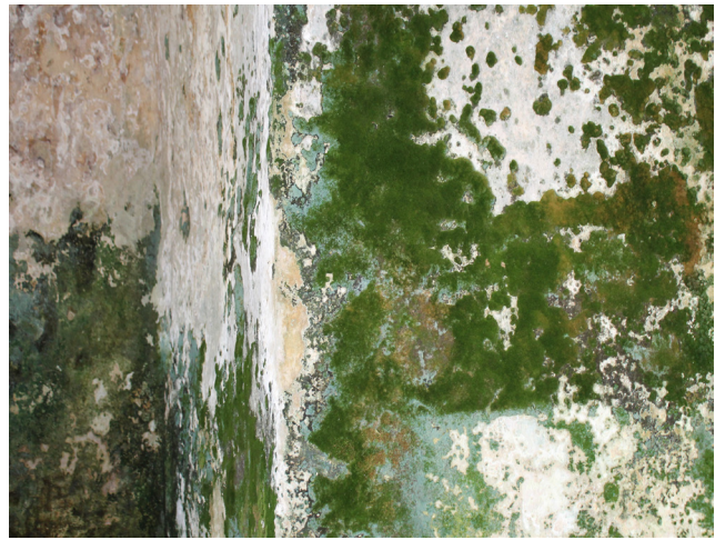
Figura 123, moho en las paredes del caso práctico 2 (2014). Fuente: imagen de autor
