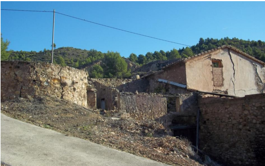
Detalle de uno de los hornos de la fábrica de Joseph Ferrer, según indicios. Estado actual
