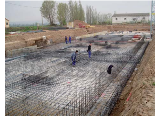
^^ Execució llosa de fonamentació, on es veu l'armat de la pròpia llosa i els armats d'espera.
