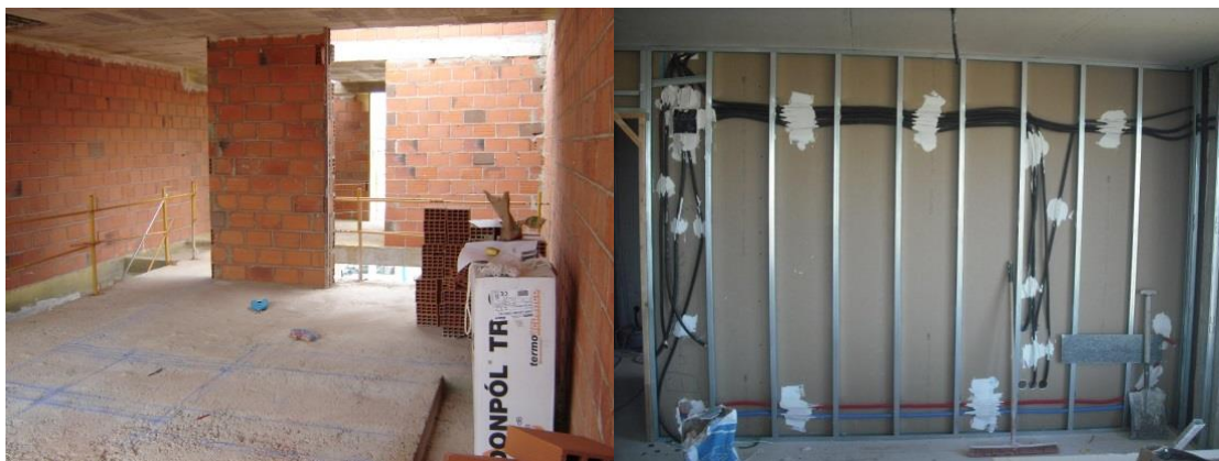
Figura 22. Varios tipos de particiones realizadas, de ladrillo cerámico y de tabiquería seca. (Elaboración propia)
