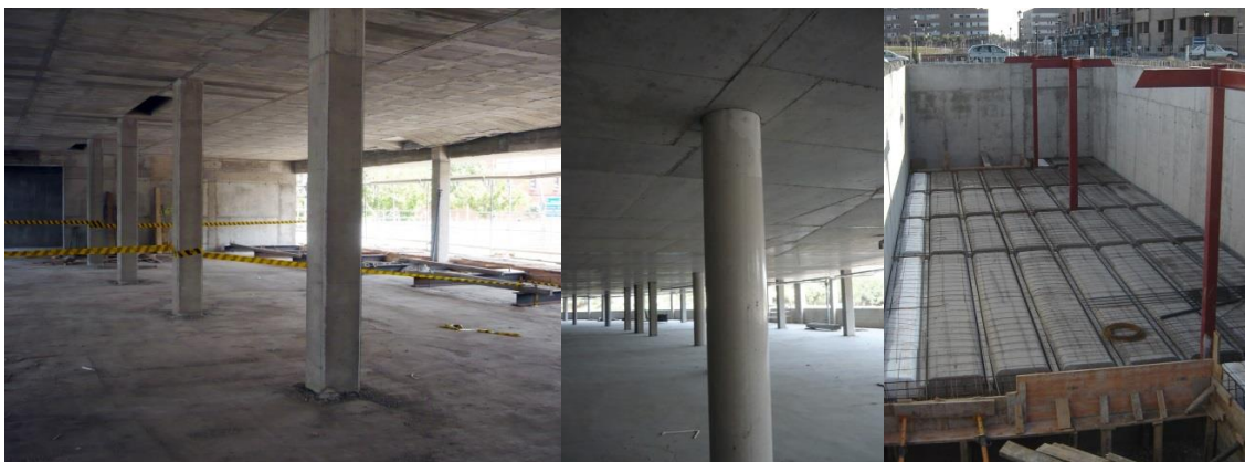
Fig 18. Ejecución de la estructura en edificio de viviendas. Elemento que quedará oculto al finalizar las obra . (Elaboración propia)
