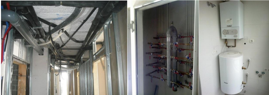
Figura 21. Diferentes tipos de instalaciones de suministro realizadas en el edificio. (Elaboración propia)
