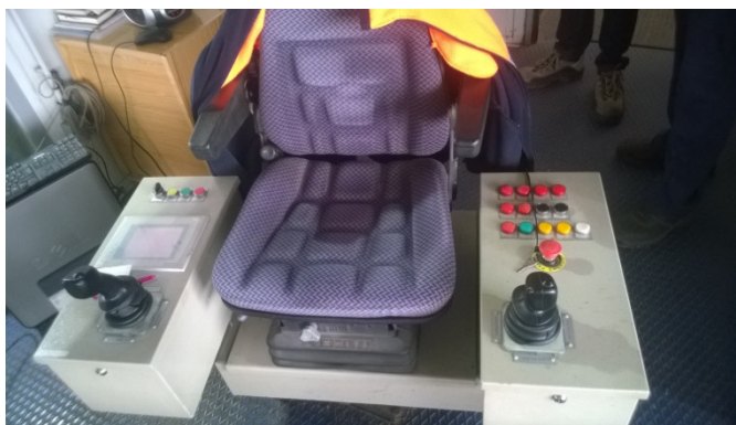
Imagen 31. Cabina de mando Puente grúa - pulpo.
