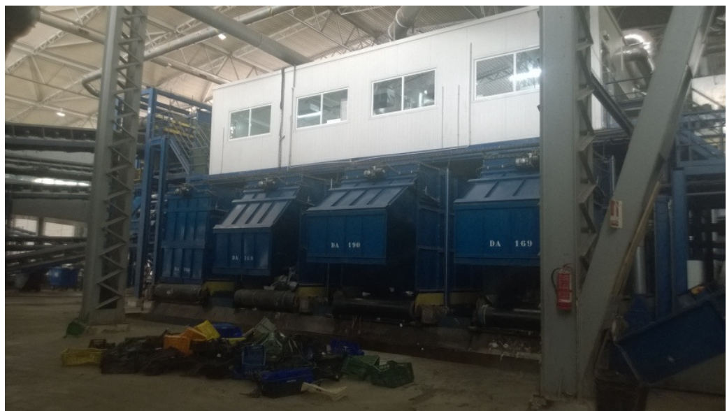
Imagen 42. Exterior de la cabina.
