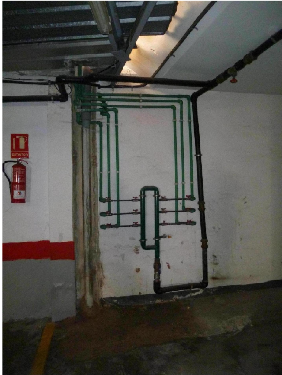
Suministro de aguas. Cuadro de contadores. [Ref. IN001]
