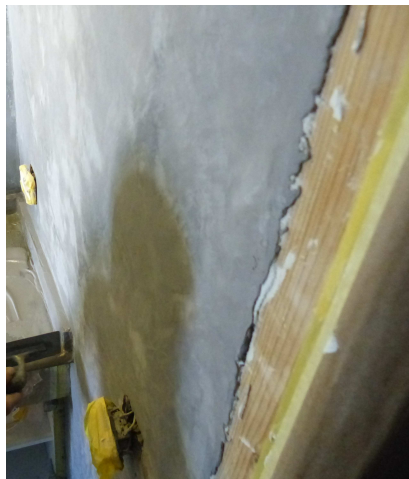
Figura 24. Encuentro revestimiento-marco de puerta. 2014.Inmobles Xúquer.
