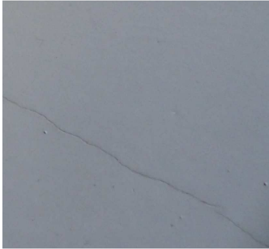
Figura 38. Fisuración del microcemento. 2014. Inmobles Xúquer.
