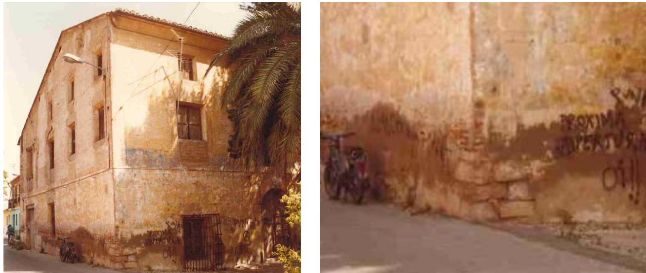
Figura 133 y 134. Humedad en las fachadas principal y lateral de la Alquería. 1984. Fuente: Catálogo de Inventario de edificios.
