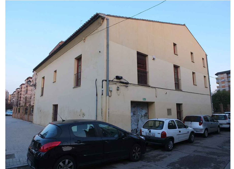
Figura 161. Esquina entre las fachadas posterior (NW) y lateral izquierdo (SW). 2014. Fuente: elaboración propia.
