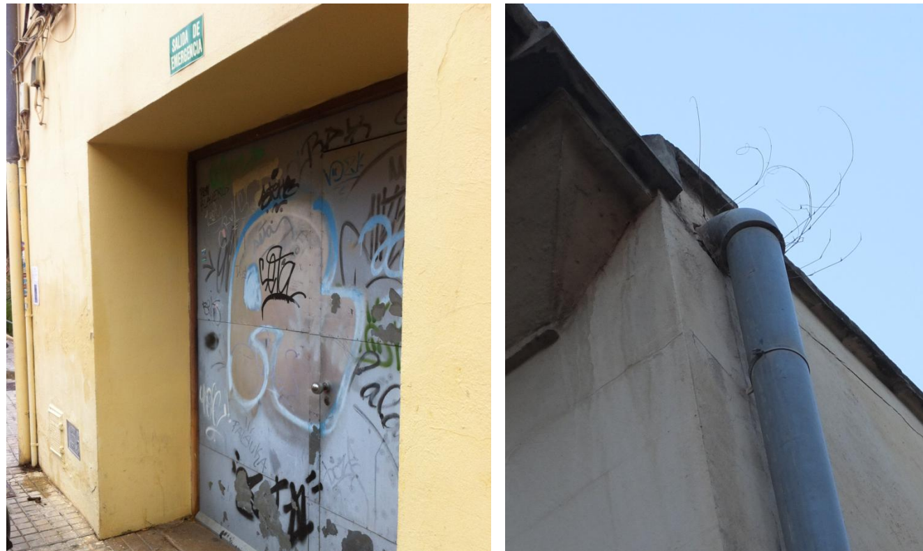
Figuras 143 y 144. Graffitis en puerta lateral y vegetación en sistema de recogida de aguas pluviales. 2014. Fuente: elaboración propia.
