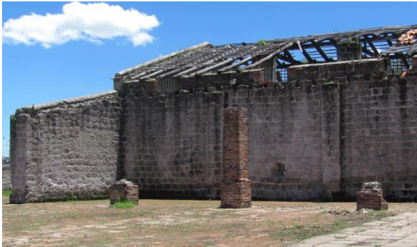
Pérdida de dos columnas de ladrillo y cubierta
