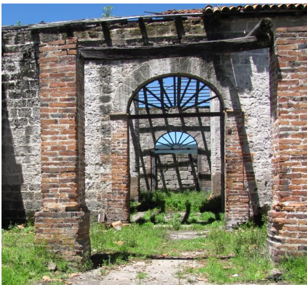
Pudrición de viga de soporte de cubierta exterior
