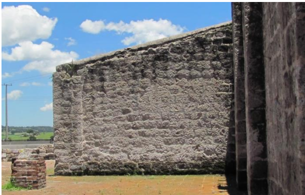
Erosión de muro en fachada noreste
