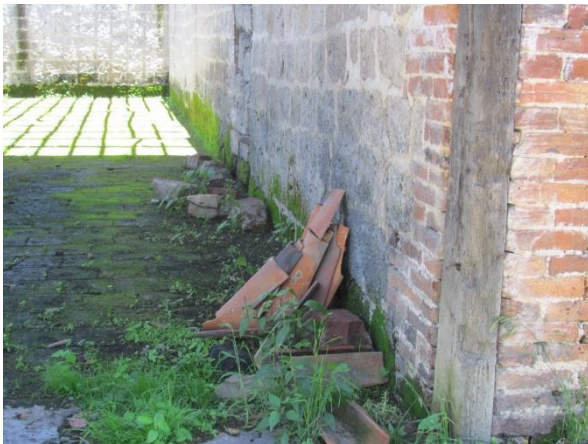
Pavimento interior con presencia de moho y líquenes
