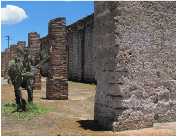
Erosión de muro en fachada noroeste
