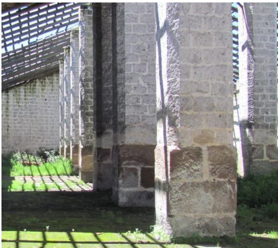
Eflorescencias en material pétreo de columnas interiores
