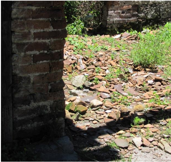
Eflorescencia en ladrillo
