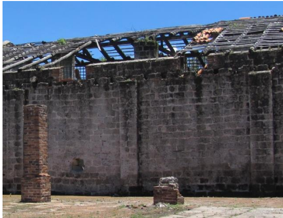
Vigas, morillos y cintas rotas en cubierta que llevo al colapso de una sección
