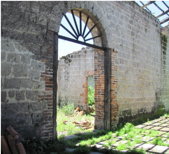
Pérdida de puertas de entrada
