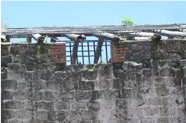
Pudrición de cabezas de vigas de madera
