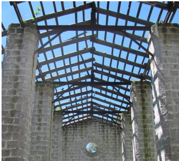
Rotura de vigas, morillos y cintas en cubierta
