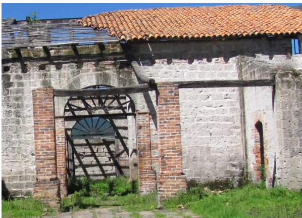
Flecha de vigas en pórtico de acceso
