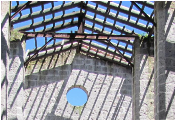
Oxidación de vigas metálica y anclajes a columnas de piedra
