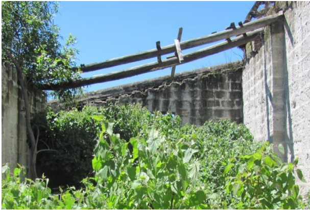
Flecha de viga en habitación dirección noreste
