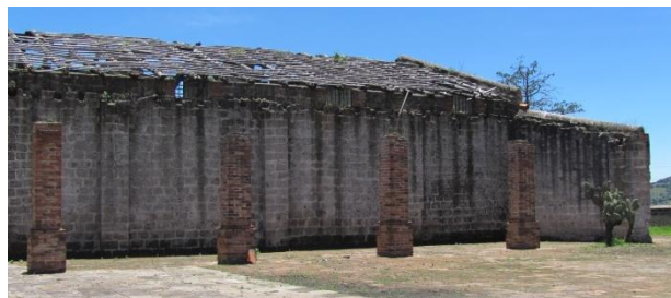
Ensuciamiento de muro en la fachada noreste
