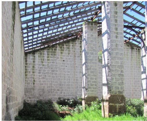
Ensuciamiento de muro interior por agentes orgánicos
