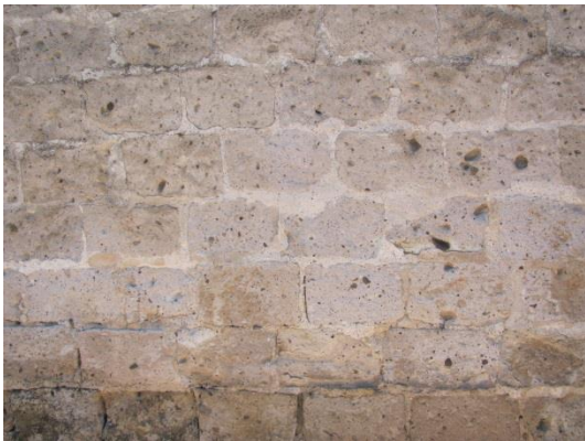
Figura. 55 Oquedades, alveolización y humedad por capilaridad en los sillares de piedra. Fotografía Diego Ortiz
