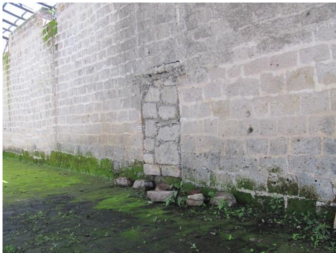
Figura. 56 Crecimiento de vegetaci3n paràsita inferior en pavimento y muro. Fotografía Diego Ortiz
