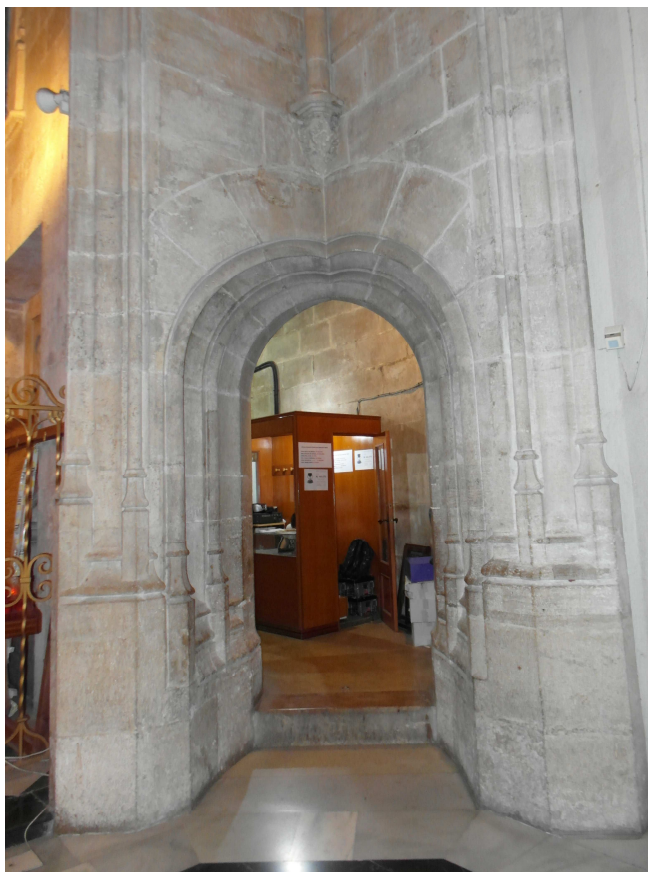
Figura 2.71. Puerta en rincón en la entrada al pasillo de acceso al Micalet ( Porta nova del angle ).
