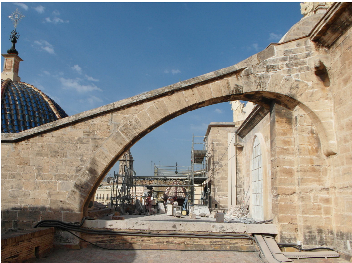
Figuras 2.105. Arbotante diseñado por Baldomar en la Arcada Nova . Podemos observar grandes diferencias con los arbotantes de los tramos anteriores de la catedral de Valencia.
