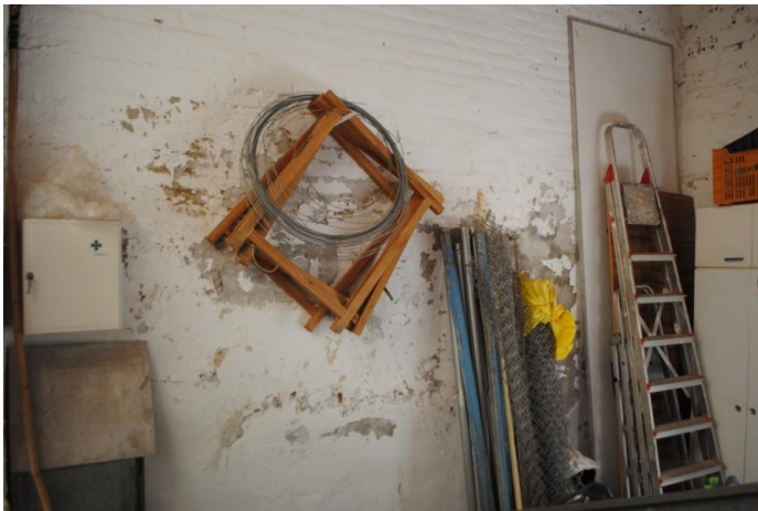
Figura 27. Humedades en el cerramiento medianero Este del garaje. 2014. Elaboración propia.
