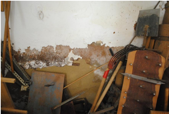
Figura 26. Humedades en el cerramiento medianero Oeste del garaje. 2014. Elaboración propia.
