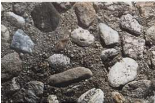
Imagen nº 14. Áridos embebidos. baja densidad de los áridos Fuente: [10]
