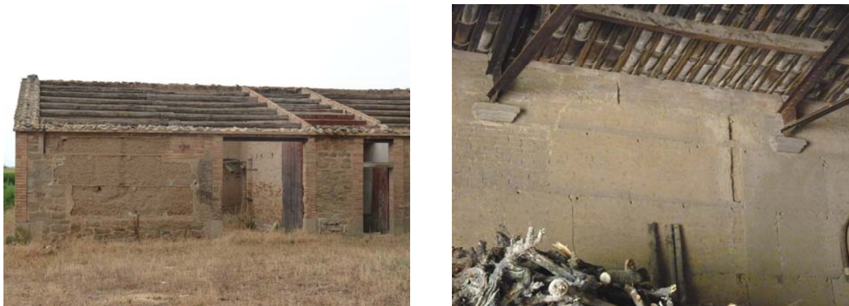
Figura 4.52. Imágenes de la solución de esquina y del refuerzo del muro.
