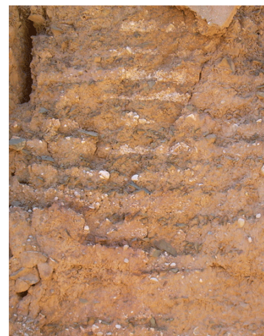
Figura 2.6. Niveles irregulares de mortero de cal entre los distintos niveles del muro.
