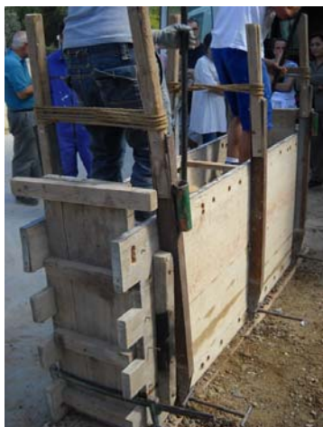
Figura 2.3. Ejecución de un muro de tapia durante los talleres prácticos del curso de restauración en construcciones de tapia del Departament de Cultura de la Generalitat de Catalunya .
