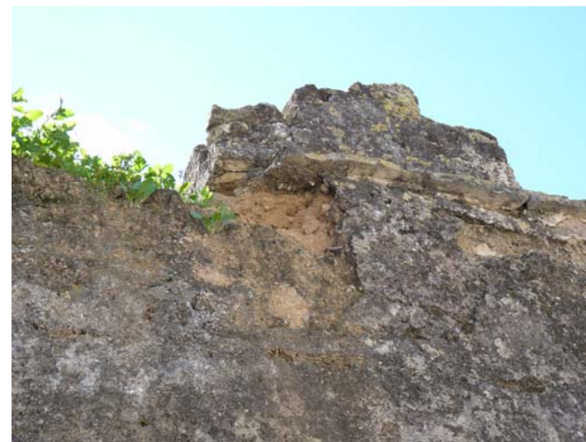
Figura 4.2. Detalle de la coronación sin intervenir.
