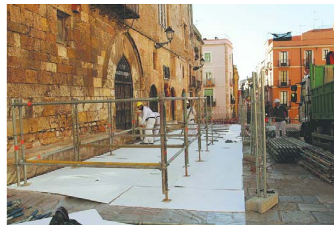
Figura 4.36. Intervención de urgencia después del temporal de noviembre de 2013.
