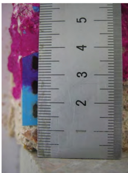
Fig. 3.34 Ensayo de fenolftaleína realizado en la probeta 2 y determinación de la profundidad del frente carbonatado.
