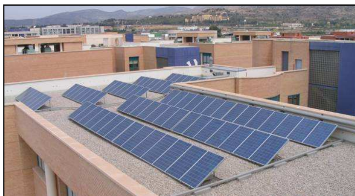
Figura 223: Placas solares sobre la cubierta de un edificio (Murcia)
