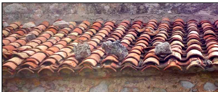
Figura 167: Colocación de piedras para fijar las tejas durante los vendavales Fuente: Pascual 2011
